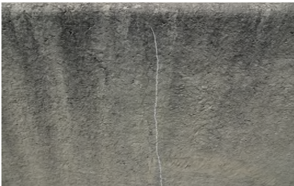
⑫ 균열 0.2mm / 1.2m
