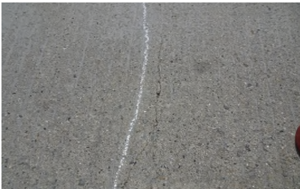
⑦ 균열 0.2mm / 2.0m
