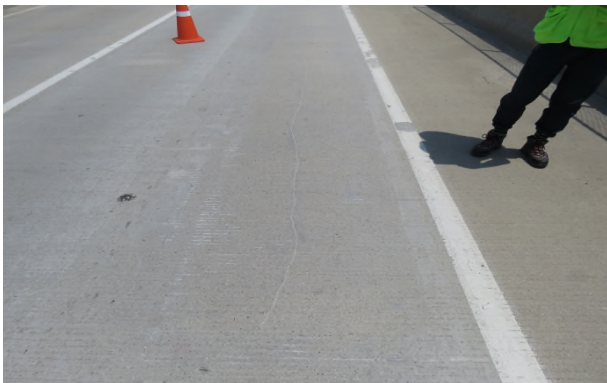
④ 균열 0.1mm / 69.0m
