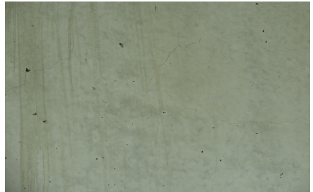
⑮ 균열 0.2mm / 1.0m
