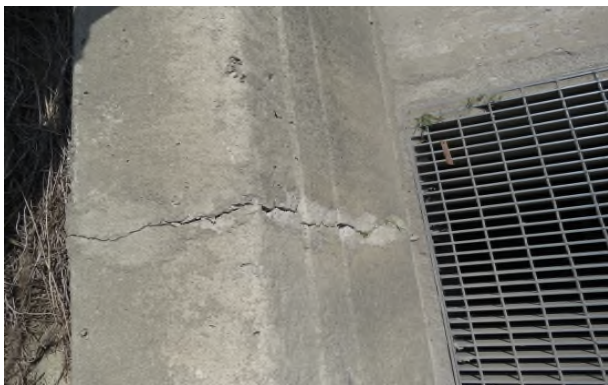
⑨ L형측구 균열 cw=0.5mm / 1.5m
