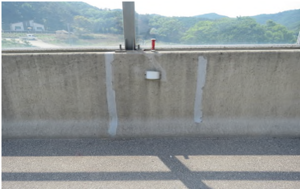
⑮ 균열 0.2mm / 1.5m (보수완료)
