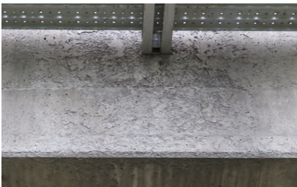
⑬ 콘크리트 열화 2.0m x 2.0m
