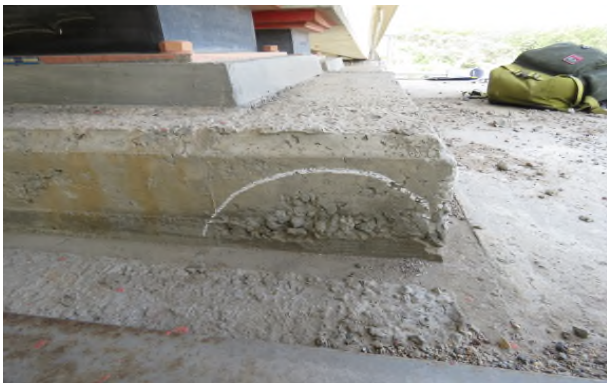
⑮ 받침콘크리트 재료분리 0.1m x 0.2m (2EA) (보수완료)
