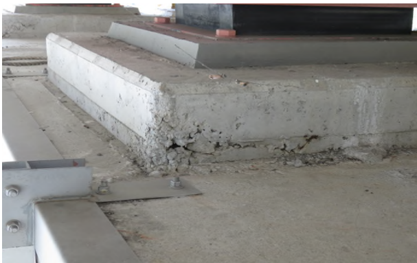
⑮ 받침콘크리트 재료분리 0.2m x 0.3m
