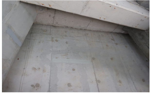
⑥ 균열부 백태 cw=0.3mm / 0.2m (보수완료)
