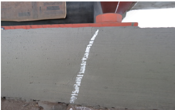
⑫ 무수축물탈균열 (0.3mm미만) cw=0.1mm / 0.1m
