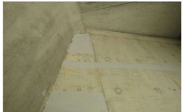
④ 가로보 파손 0.5m x 0.5m (보수완료)
