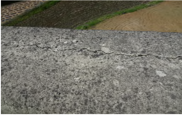
① 균열 0.2mm / 2.0m
