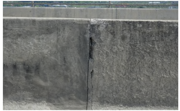
③ 파손 0.1m x 0.5m
