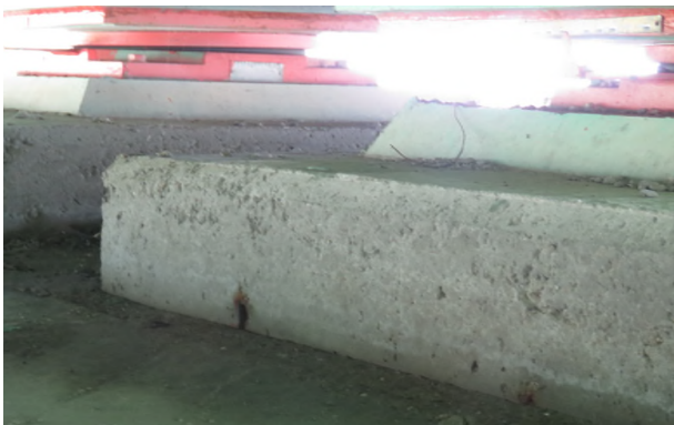
⑪ 받침콘크리트 재료분리 0.2m x 0.8m
