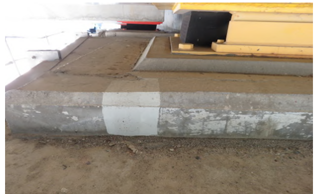
⑥ 받침콘크리트 균열 (0.3mm미만) cw=0.2mm / 0.2m (3EA) (보수완료)
