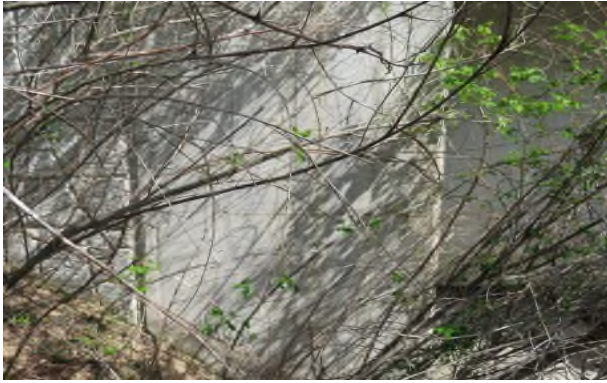
② 균열 cw=0.3mm / 1.0m (보수완료)
