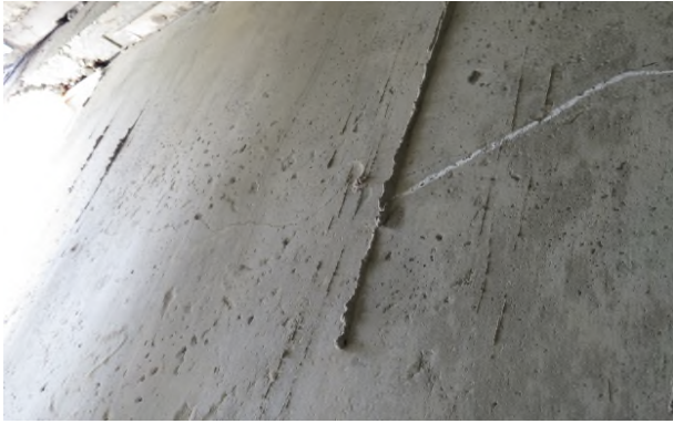
㉔ 거더 단부 균열 (0.3mm미만) cw=0.2mm / 1.2m
