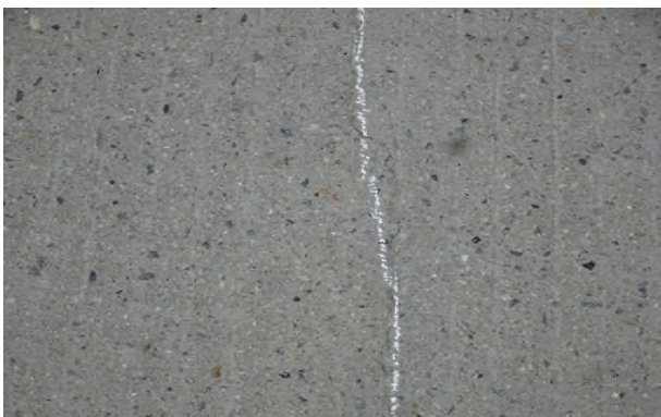
⑨ 균열 0.3mm / 2.0m
