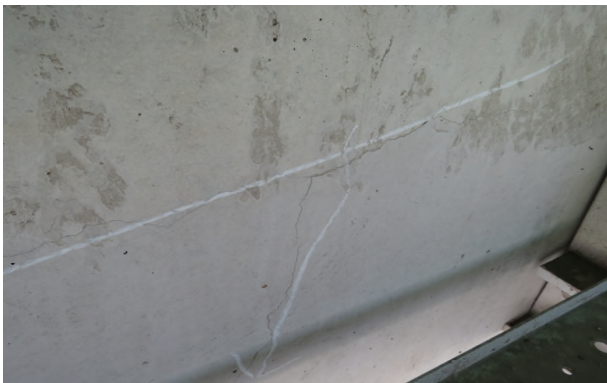
⑲ 균열 0.2mm / 2.0m
