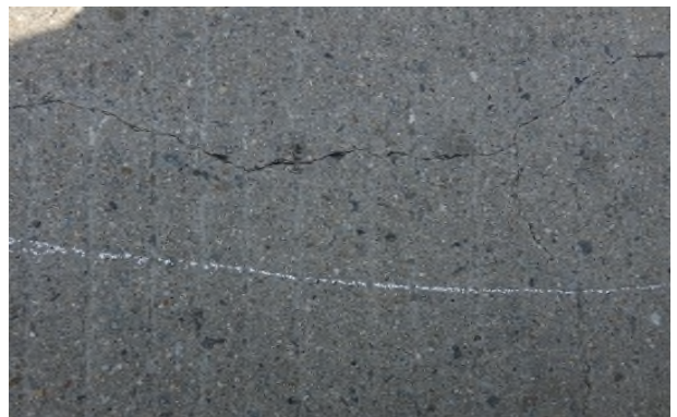
⑩ 균열 0.1mm / 3.0m
