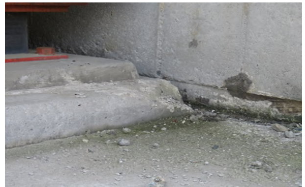
⑥ 받침콘크리트 파손 0.1m x 0.1m
