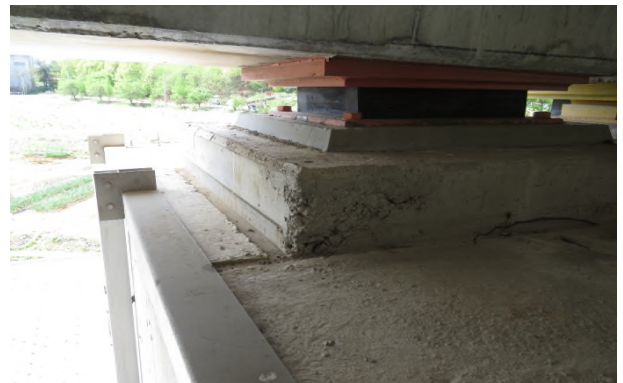
⑯ 받침콘크리트 재료분리 0.1m x 0.3m
