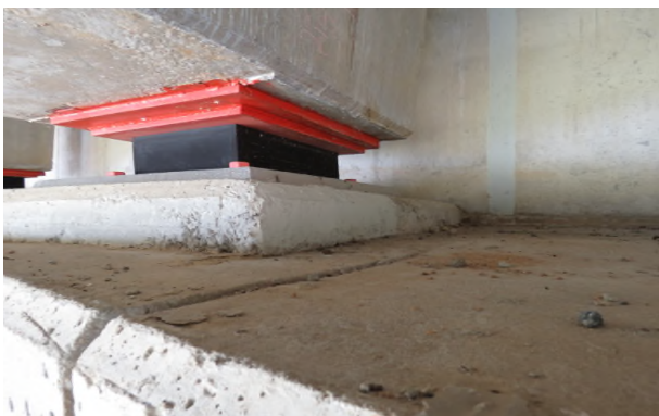
⑪ 받침콘크리트 재료분리 0.1m x 0.5m (보수완료)
