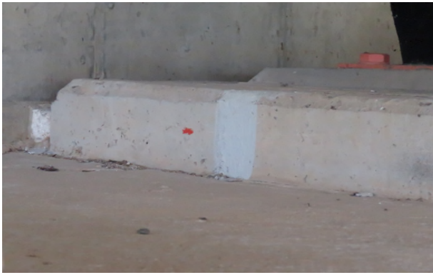
⑩ 받침콘크리트 균열 (0.3mm미만) cw=0.2mm / 0.3m (2EA) (보수완료)
