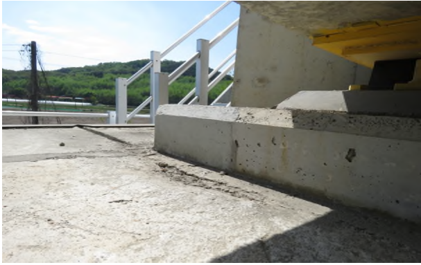
⑩ 받침콘크리트 재료분리 0.1m x 0.1m (보수완료)
