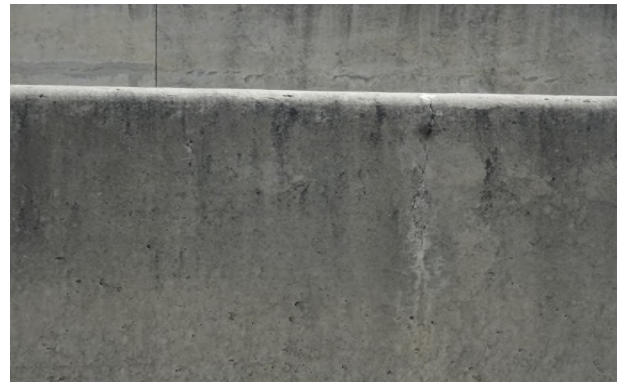
⑤ 균열 0.3mm / 0.7m
