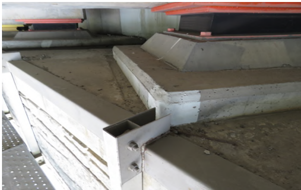
⑫ 받침콘크리트 철근노출 (1EA) (보수완료)
