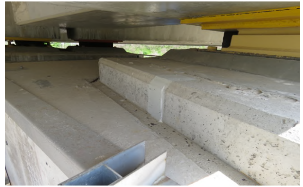
④ 받침콘크리트 균열 cw=0.3\text{mm} / 0.3\text{m} (보수완료)
