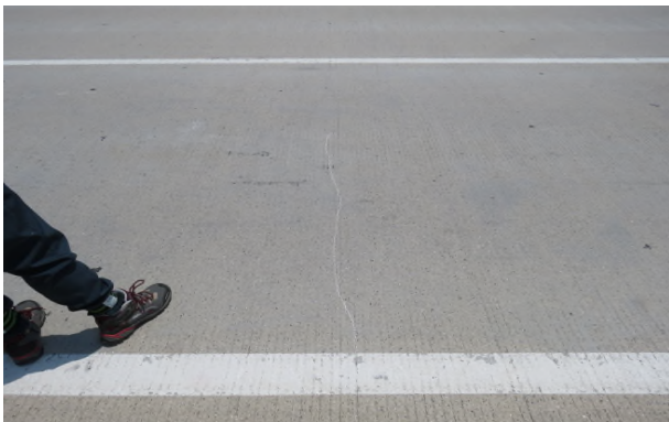
⑬ 균열 0.2mm / 1.0m
