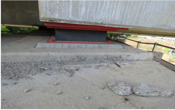
⑱ 받침콘크리트 재료분리 0.1m x 0.5m (2EA)
