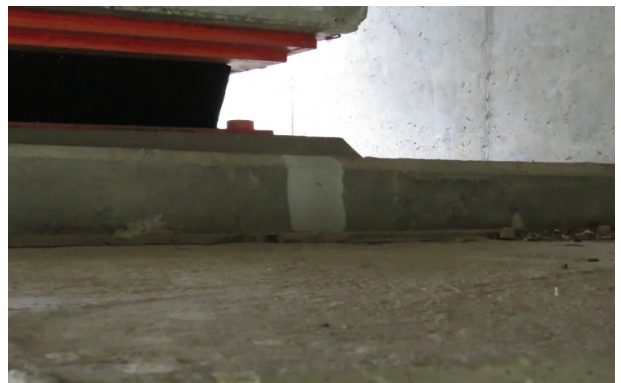
⑧ 받침콘크리트 균열 (0.3mm미만) cw=0.2mm / 0.5m (보수완료)
