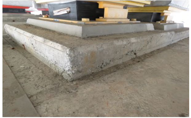
⑬ 받침콘크리트 재료분리 0.2m x 0.2m
