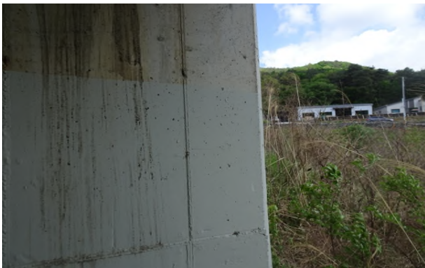
⑳ 균열 0.3mm / 0.6m (보수완료)
