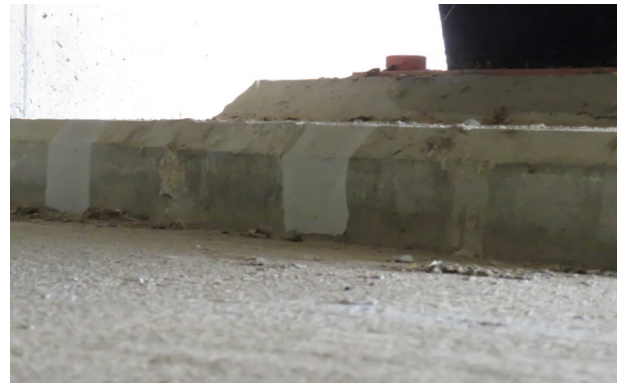
⑥ 받침콘크리트 균열 (0.3mm미만) cw=0.2mm / 0.5m (2EA) (보수완료)
