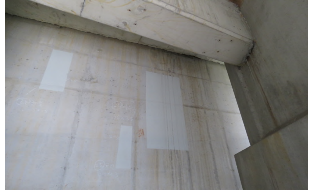
㉕ 누수흔적 0.6m x 3.5m (보수완료)
