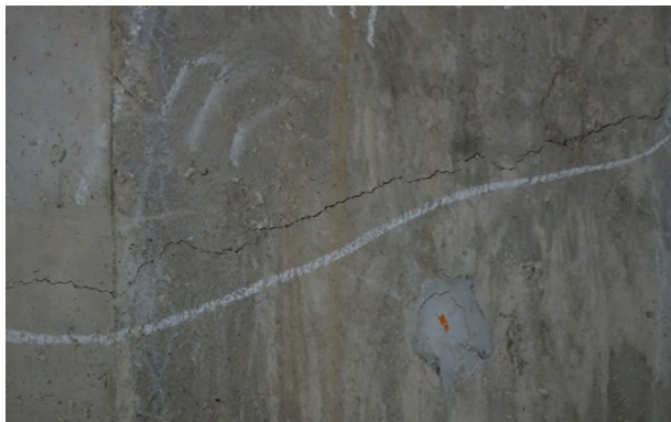
⑬ 균열 0.2mm / 1.0m
