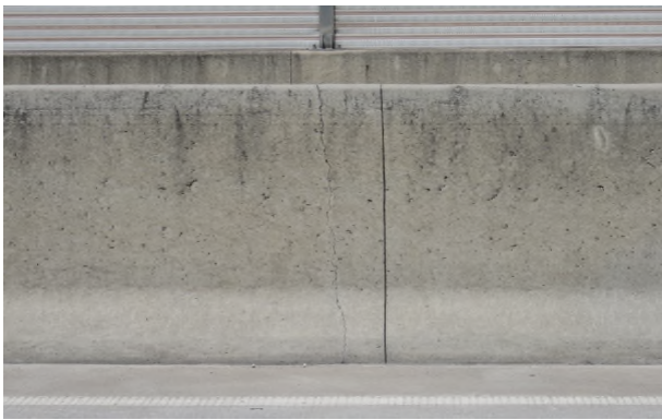
⑳ 균열 0.3mm / 1.5m
