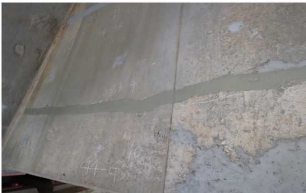
⑩ 균열 0.3mm / 2.0m (보수완료)
