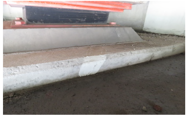
⑪ 받침콘크리트 균열 (0.3mm미만) cw=0.1mm / 0.1m (보수완료)
