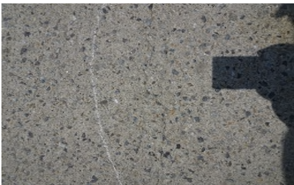
⑫ 균열 0.1mm / 2.0m
