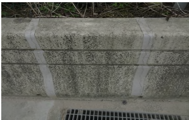
⑦ L형측구 균열 cw=0.5mm / 1.5m
