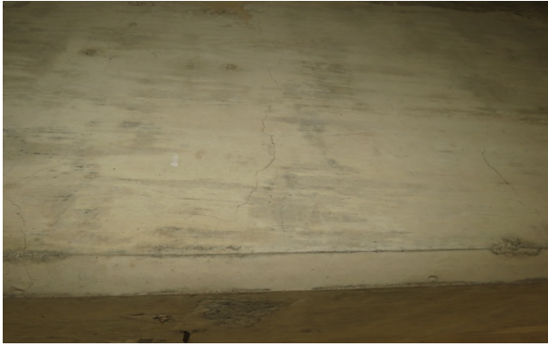
㉑ 균열 0.2mm / 0.4m (8EA)
