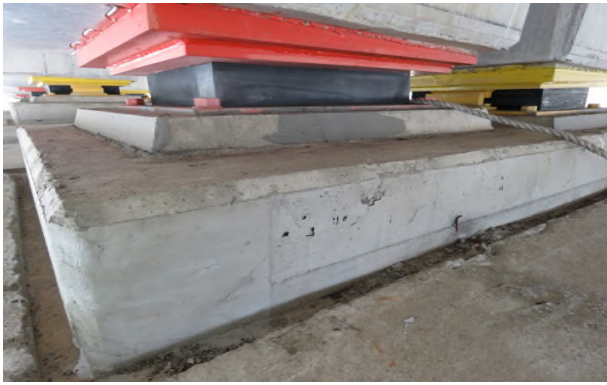
⑬ 받침콘크리트 재료분리 0.2m x 0.1m
