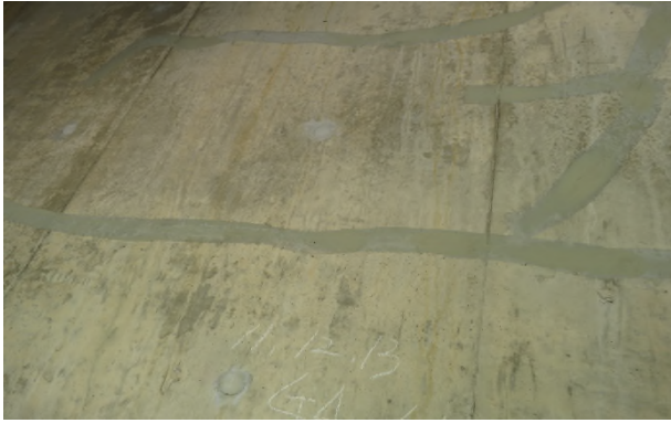
⑫ 균열 0.3mm / 0.5m (보수완료)
