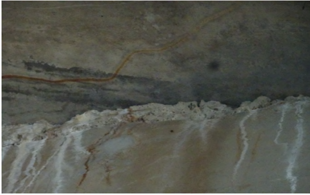
⑤ 파손 0.1m x 0.5m
