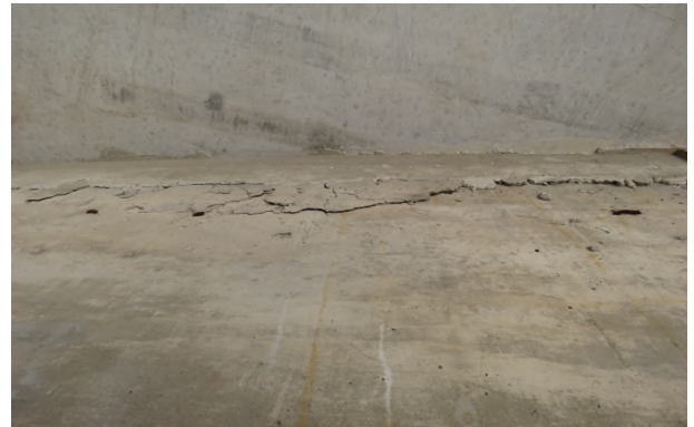
⑱ 파손 0.1m x 0.4m
