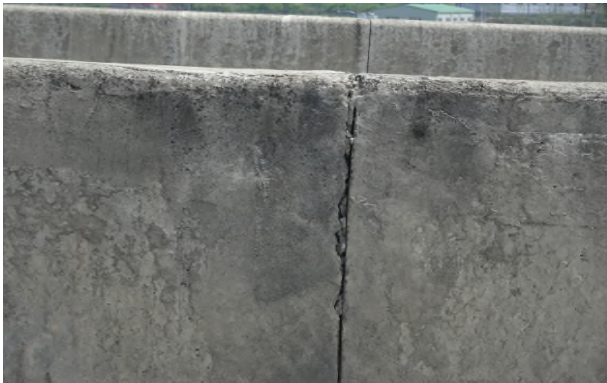
⑩ 파손 0.1m x 0.6m
