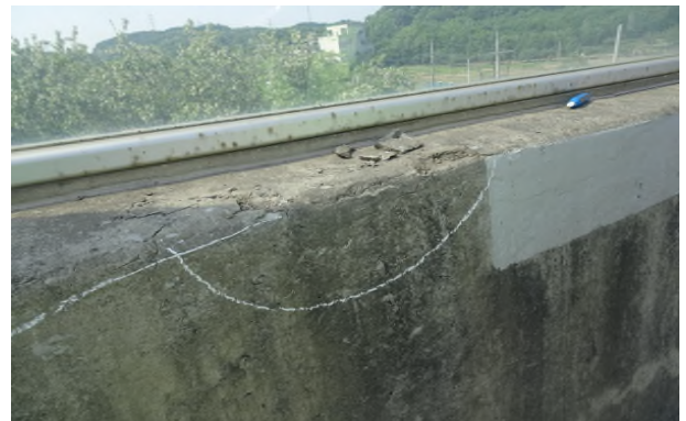
㉒ 파손 0.2m x 0.1m
