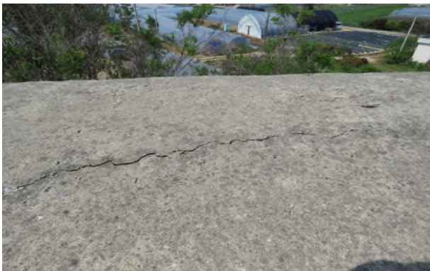
③ 균열 cw=0.3\text{mm} / 0.4m
