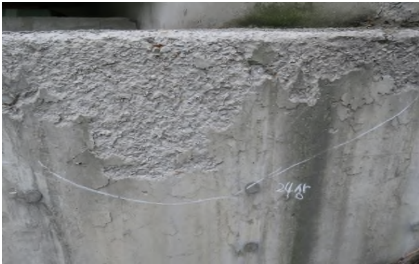
㉡ 콘크리트 열화 1.5m x 0.5m
