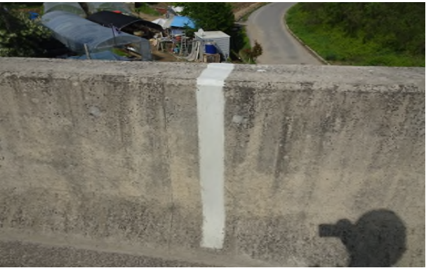
⑤ 균열 (0.3mm미만) cw=0.1mm / 0.8m(보수완료)
