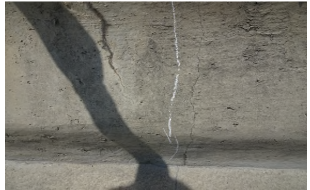
⑪ 균열 0.2mm / 0.6m
