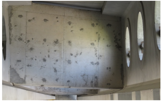
③ 파손 및 굽힘 0.8m x 0.1m (보수완료)
