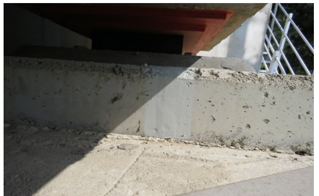
⑮ 받침콘크리트 균열 (0.3mm미만) cw=0.1mm / 0.3m (보수완료)
