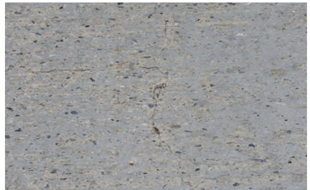
⑥ 균열 0.1mm / 43.0m
