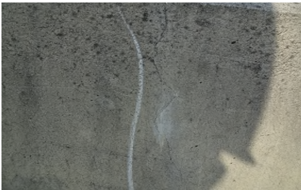
㉗ 균열 (0.3mm미만) cw=0.1mm / 0.3m
