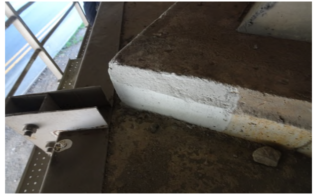
⑨ 받침콘크리트 재료분리 0.1m x 0.1m (보수완료)
