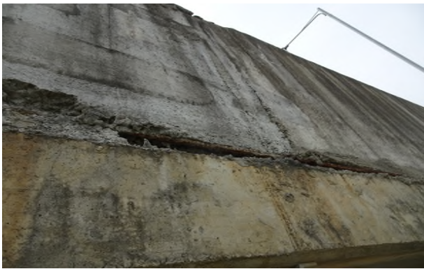
⑬ 파손 및 철근노출 0.2m x 1.0m
