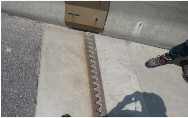
① 신축이음부 이물질퇴적 L=0.5m
