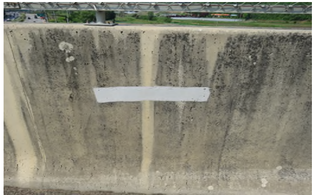
⑭ 균열 (0.3mm미만) cw=0.1mm / 0.3m (보수완료)
