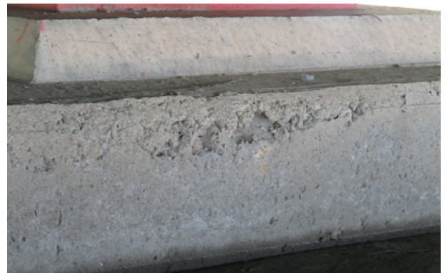
⑫ 받침콘크리트 재료분리 0.2m x 0.3m
