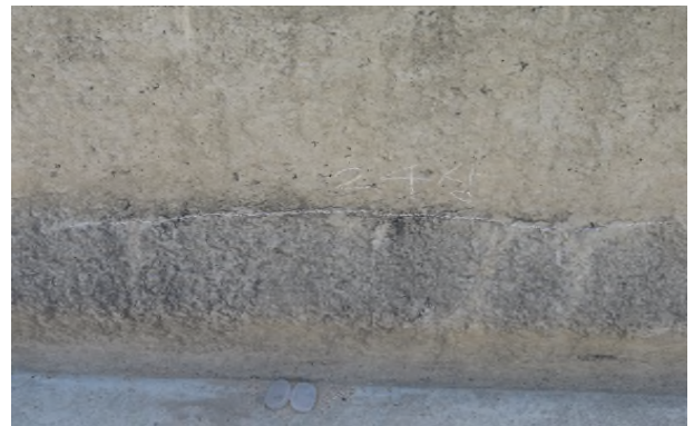
⑨ 균열 0.1mm / 1.1m
