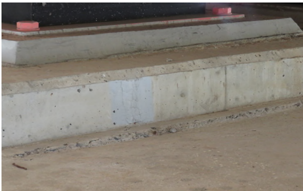
⑩ 받침콘크리트잡철근미제거 (보수완료)
