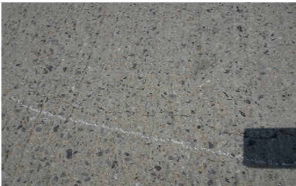
⑧ 균열 0.1mm / 0.4m
