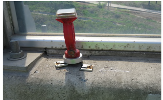
㉔ 델리네이트 파손 (1EA)
