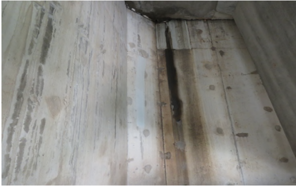
⑤ 균열 (0.3mm미만) cw=0.1mm / 1.0m (보수완료)
