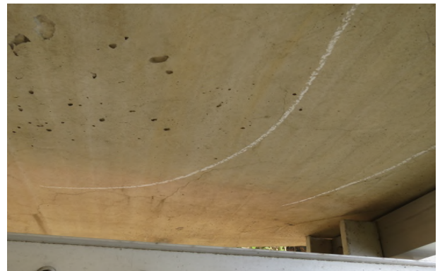
⑱ 균열 (0.3mm미만) cw=0.2mm / 1.0m (2EA)
