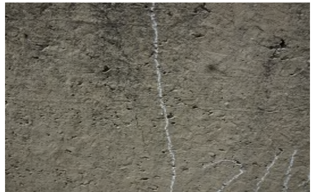
⑳ 균열 0.2mm / 1.2m
