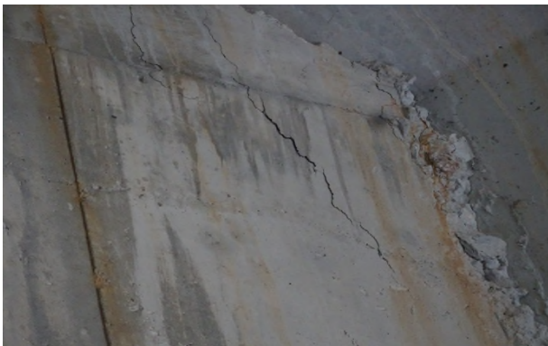
③ 균열 0.1mm / 0.5m
