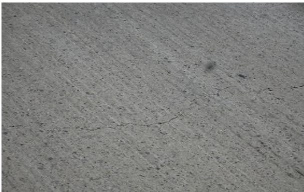
⑩ 균열 0.2mm / 5.0m
