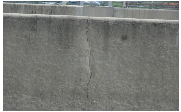
② 균열 0.3mm / 1.5m
