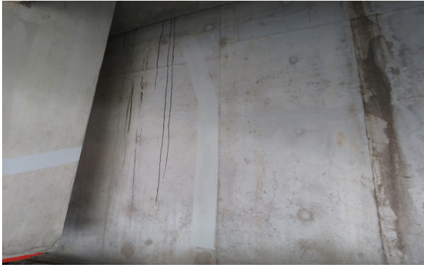
① 균열 cw=0.3mm / 2.0m (보수완료)
