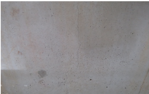
㉒ 균열 0.1mm / 1.5m
