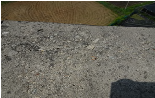
⑰ 균열 0.1mm / 10.0m
