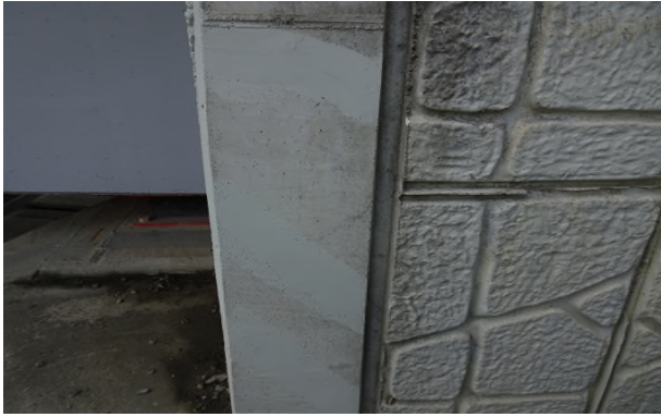
㉒ 균열 0.3mm / 0.3m (4EA) (보수완료)
