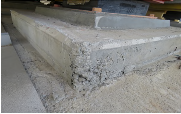
⑨ 받침콘크리트 재료분리 0.2m x 0.2m
