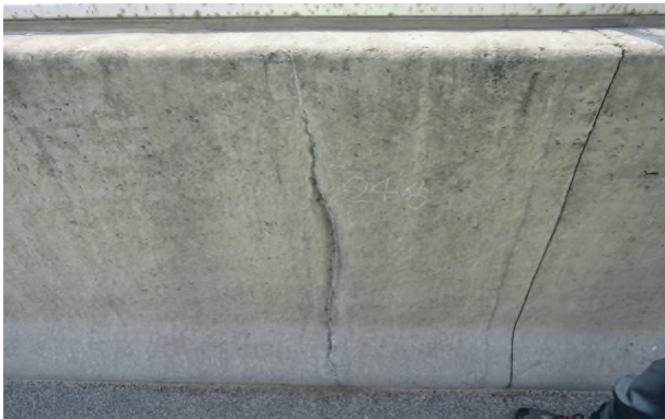
⑮ 균열 0.2mm / 1.4m
