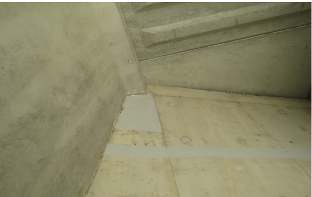
⑤ 가로보 재료분리 1.0m x 0.5m (보수완료)
