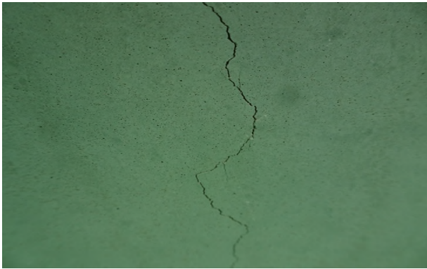
③ 균열 0.2mm / 0.3m (4EA)
