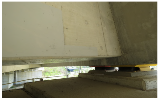
⑧ 가로보 재료분리 0.7m x 0.1m (보수완료)
