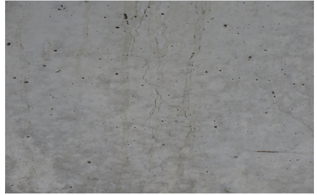
⑪ 균열 0.2mm / 2.0m
