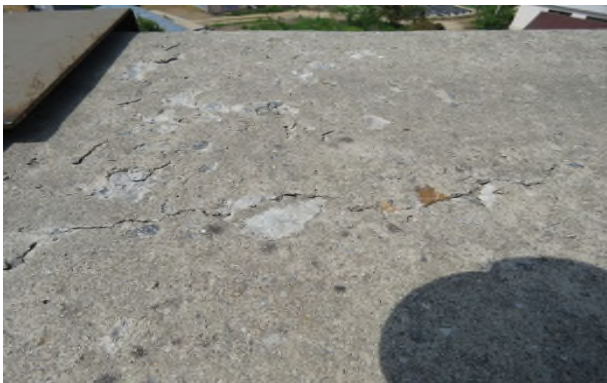
⑤ 균열 cw=0.3\text{mm} / 3.0m
