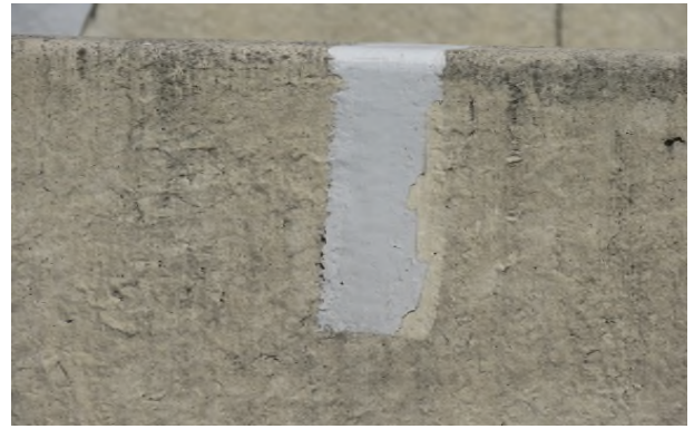
③ 균열 0.1mm / 0.3m (보수완료)
