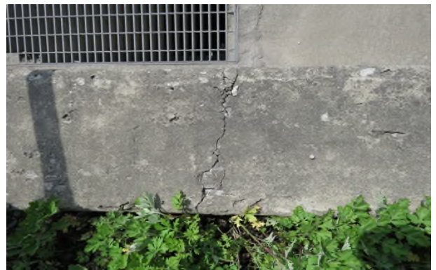
⑫ 균열 cw=1.0mm / 1.0m
