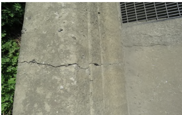
⑤ L형측구 균열 cw=0.5mm / 1.5m
