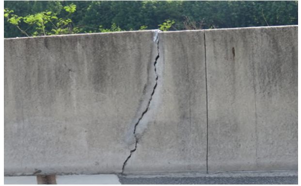
㉖ 파손 0.05m x 1.6m
