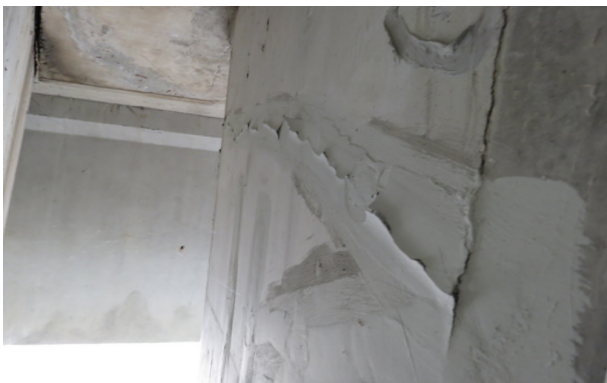
⑦ 균열 cw=0.3mm / 3.5m (보수완료)
