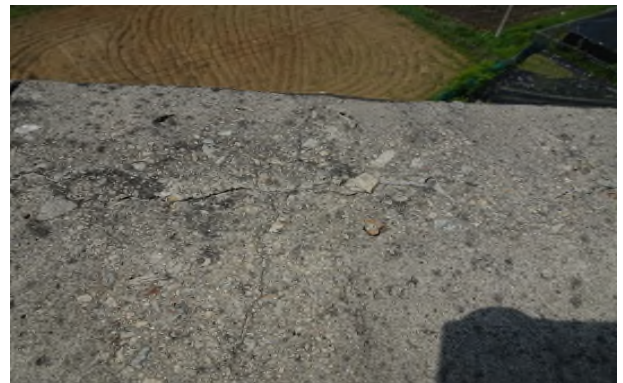
⑱ 균열 1.0mm / 0.8m
