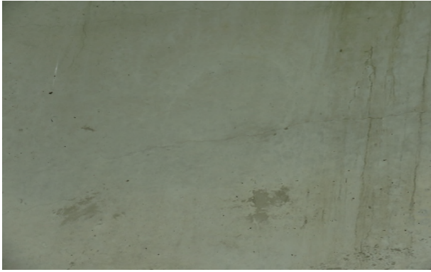
⑩ 균열 0.2mm / 8.0m
