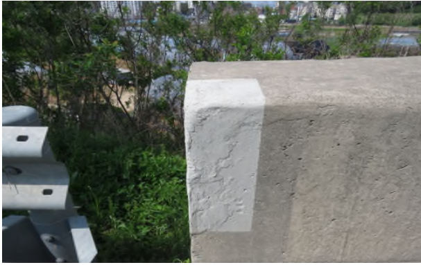
① 파손 0.1m x 0.1m (보수완료)
