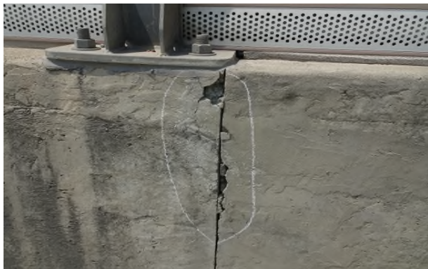
㉔ 파손 0.1m x 0.4m
