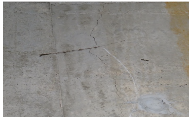
㉔ 균열 0.3mm / 1.0m
