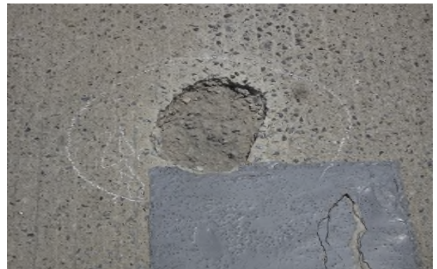
⑨ 파손 0.2m x 0.2m
