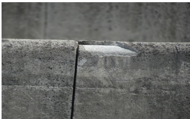
㉘ 파손 0.1m x 0.1m
