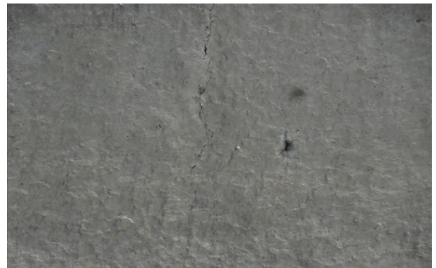
④ 균열 0.2mm / 1.5m (2EA)
