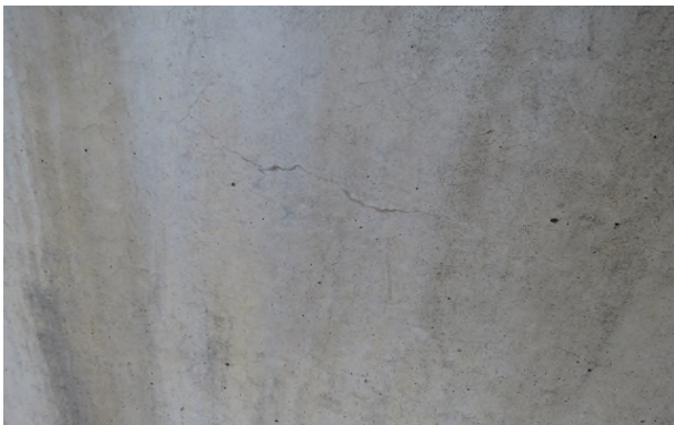
⑳ 균열 0.1mm / 0.5m
