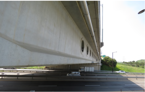
⑧ 파손 및 균열 0.8m x 0.1m (보수완료)
