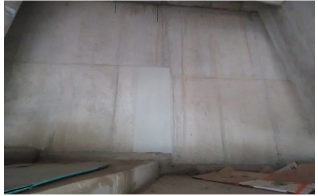
② 균열 cw=0.3mm / 1.2m (보수완료)
