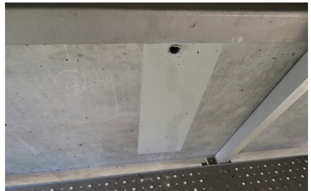
⑬ 균열(0.3mm미만) cw=0.1mm / 0.3m (보수완료)
