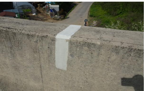
⑦ 균열(0.3mm미만) cw=0.2mm / 0.8m(보수완료)
