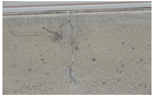
㉑ 균열 0.3mm / 1.5m
