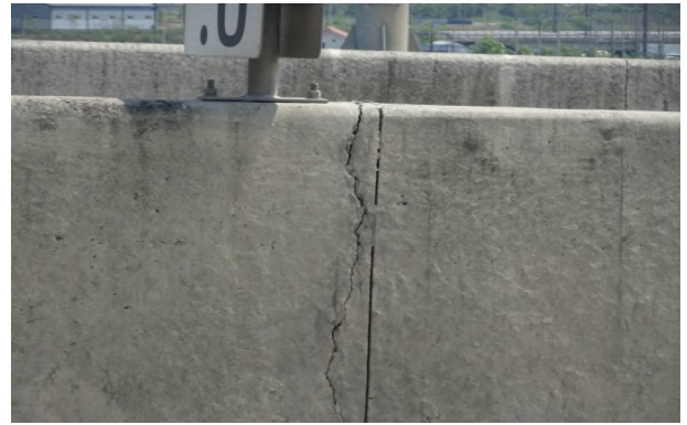
⑩ 균열 0.2mm / 0.8m
