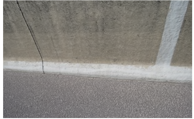
② 균열 cw=0.3mm / 3.0m (보수완료)
