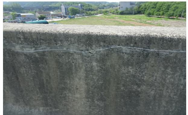
⑫ 균열 cw=0.3mm / 2.0m
