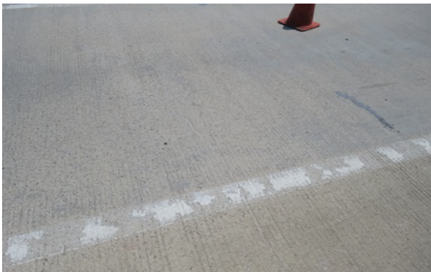
⑦ 균열 0.1mm / 1.2m
