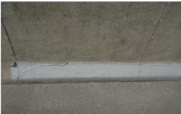
⑭ 균열 0.3mm / 2.5m (보수완료)
