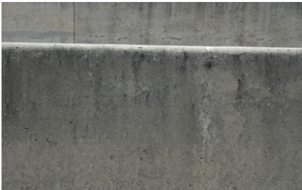
② 균열 0.3mm / 1.5m
