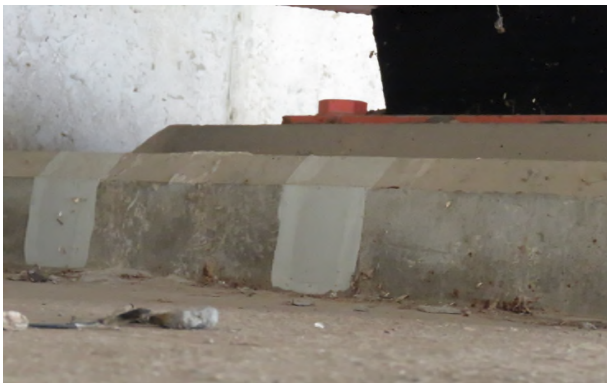
③ 받침콘크리트 균열 (0.3mm미만) cw=0.2mm / 0.2m (3EA) (보수완료)
