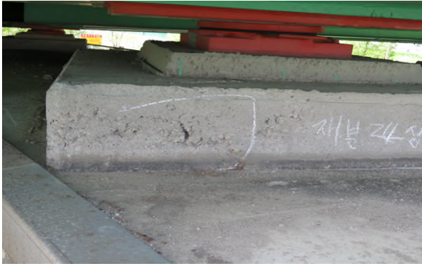
① 받침콘크리트 재료분리 0.3m x 0.6m
