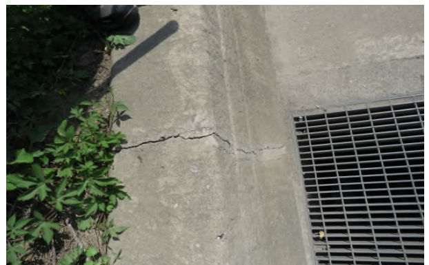
⑧ L형측구 균열 cw=0.5mm / 1.5m
