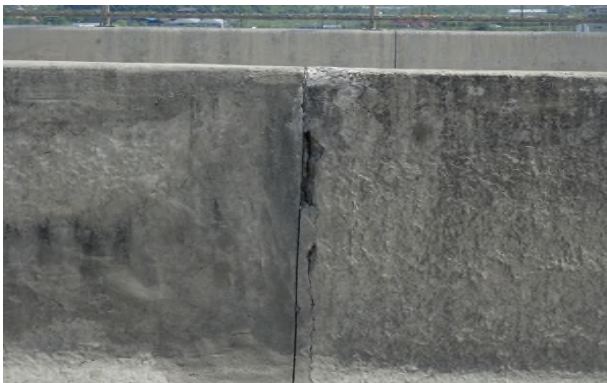
④ 균열 0.5mm / 1.5m (2EA)
