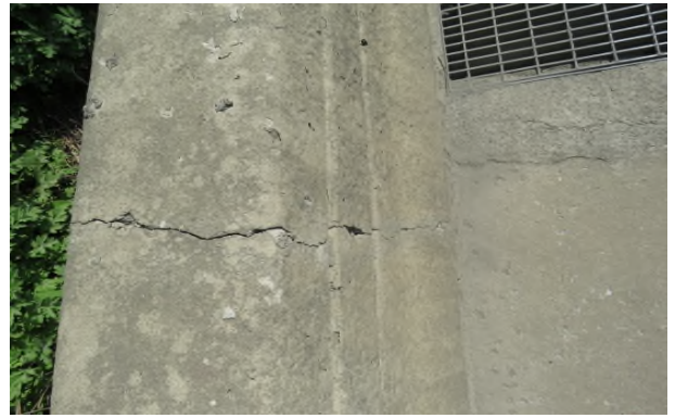
④ L형측구 균열 cw=0.5mm / 1.5m
