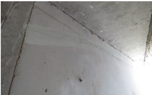
③ 균열 cw=0.3mm / 1.2m (보수완료)
