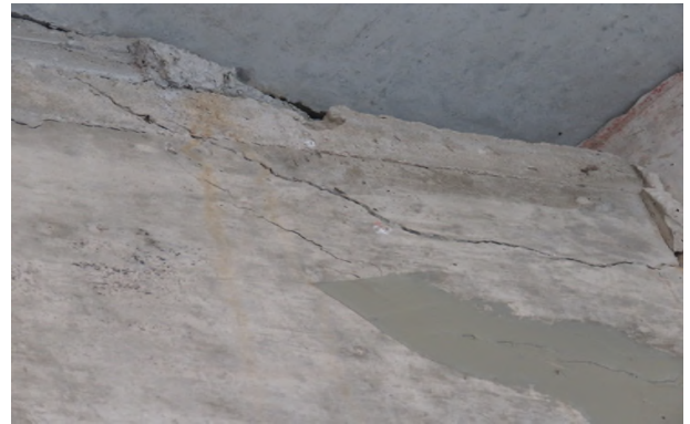
㉖ 균열 0.5mm / 0.4m
