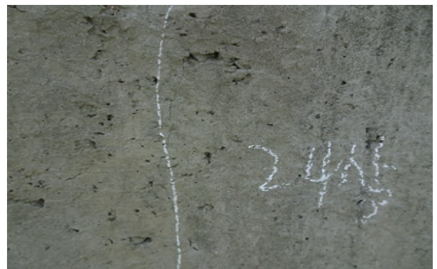
⑲ 균열 0.2mm / 1.2m
