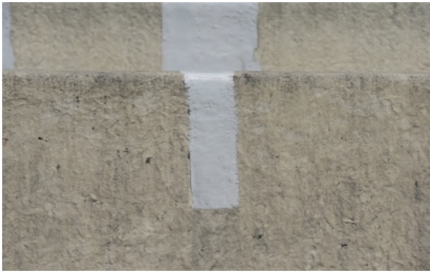
② 균열 0.2mm / 0.3m (보수완료)
