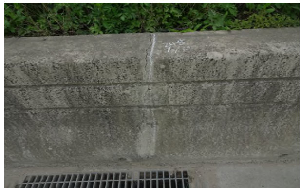
⑪ 균열 cw=1.0mm / 1.0m
