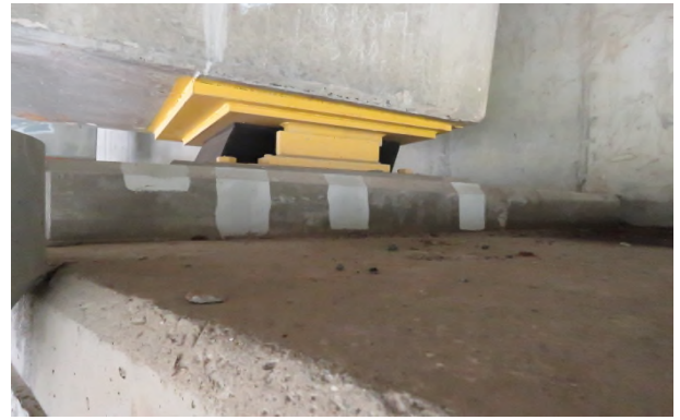
⑪ 받침콘크리트 균열 (0.3mm미만) cw=0.2mm / 0.3m (3EA) (보수완료)
