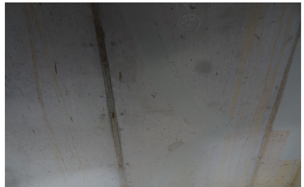
⑬ 균열 0.05mm / 0.8m (보수완료)
