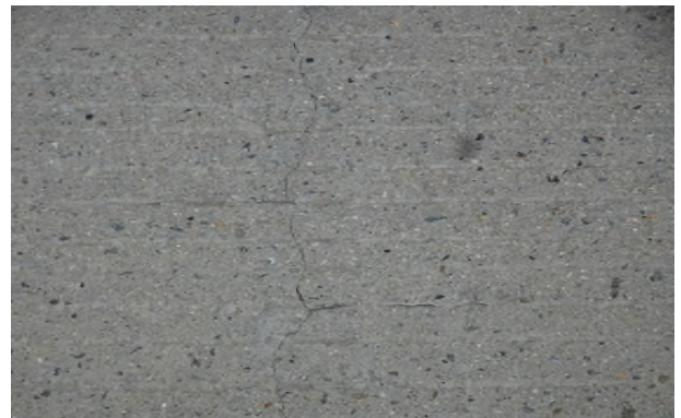
⑧ 균열 0.3mm / 37.0m
