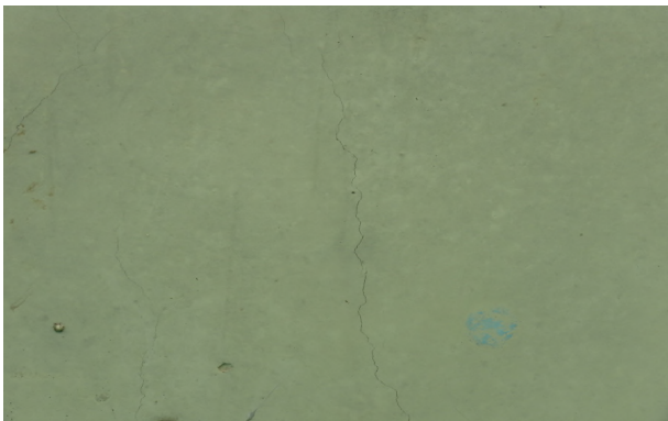
⑦ 균열 0.1mm / 0.8m (8EA)
