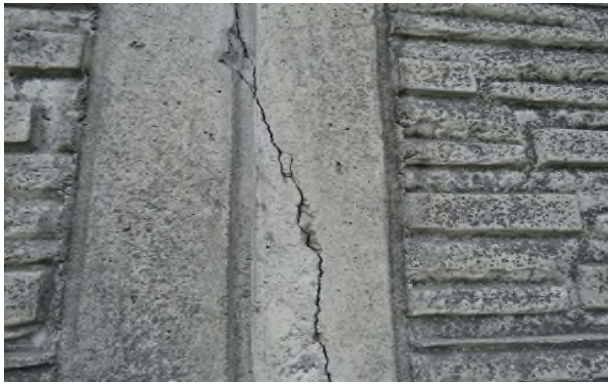
① L형측구 균열 cw=1.0\text{mm} / 1.1m
