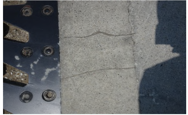
② 신축이음 토사퇴적 L=2.0m (보수완료)
