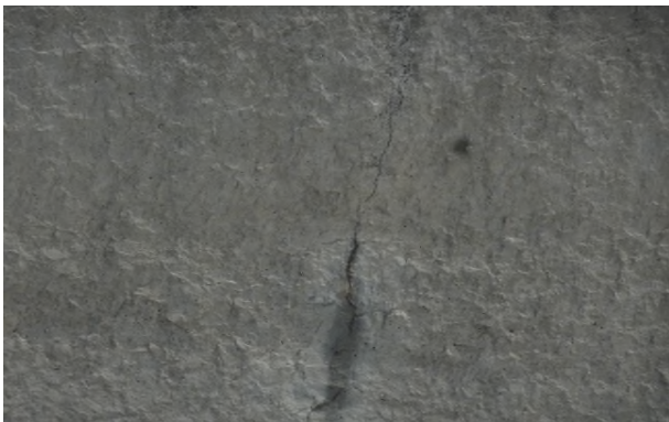
③ 균열 0.3mm / 0.5m
