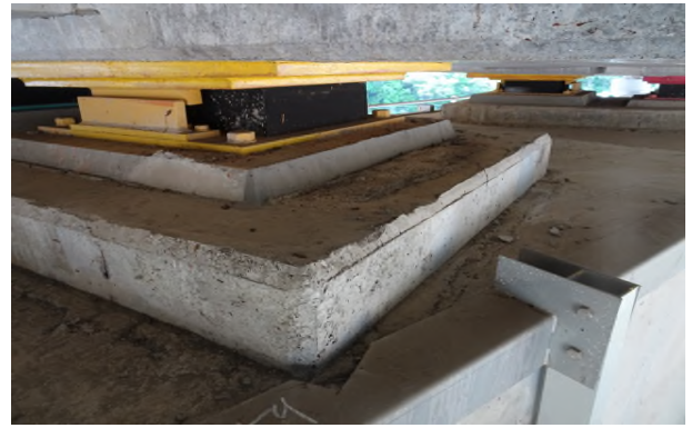
⑬ 받침콘크리트 표면불량 0.1m x 0.1m
