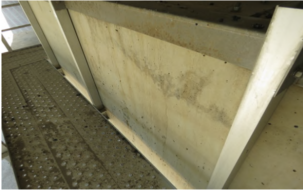
㉔ 파손(균함) 0.1m x 0.5m (2EA) (보수완료)
