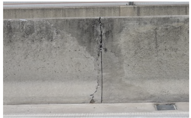
⑥ 균열 0.3mm / 0.7m
