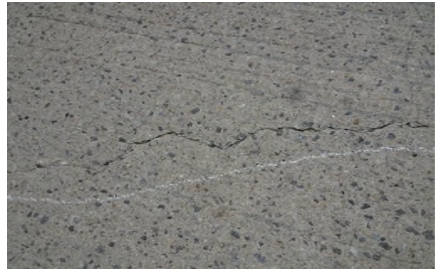
⑦ 균열 0.2mm / 0.5m
