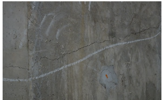
⑫ 균열 0.1mm / 0.7m
