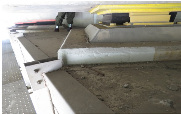
⑩ 받침콘크리트 재료분리 0.1m x 0.1m (보수완료)
