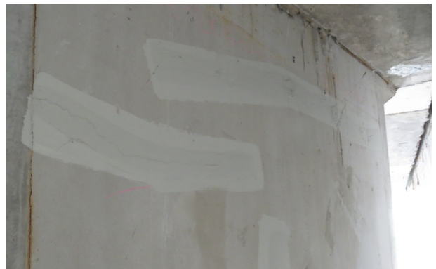
⑥ 균열 cw=0.3mm / 5.0m (보수완료)
