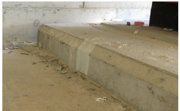
⑧ 받침콘크리트 균열 (0.3mm미만) cw=0.2mm / 0.1m (보수완료)
