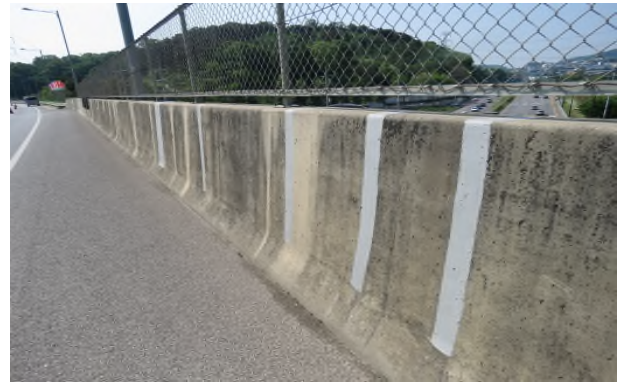
⑱ 균열 cw=0.3mm / 1.2m (보수완료)
