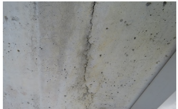
⑬ 균열 0.3mm / 0.9m
