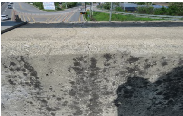
㉡ 균열 (0.3mm미만) cw=0.1mm / 0.3m (15EA)
