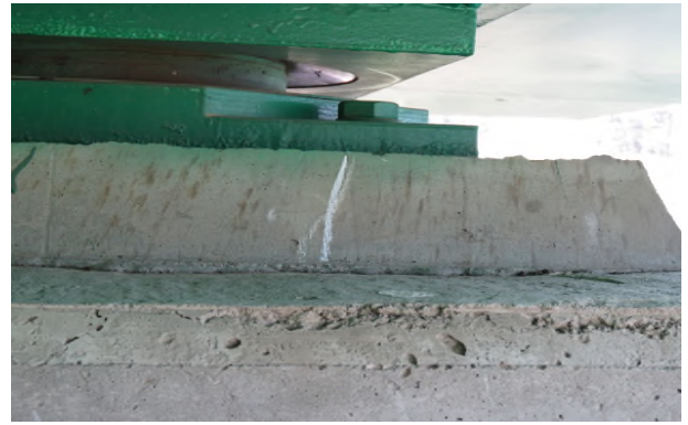
⑭ 균열 0.2mm / 0.5m
