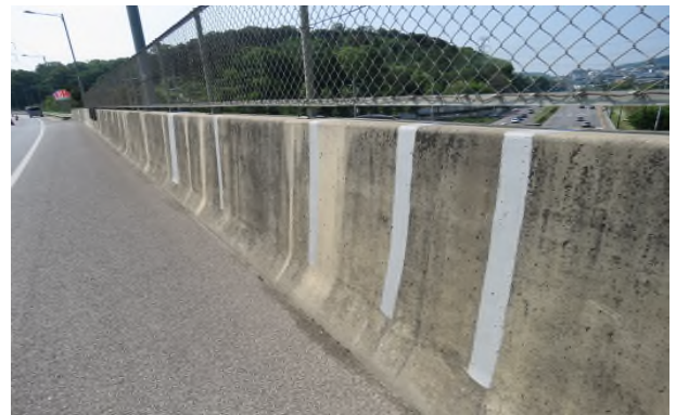
⑳ 균열 cw=0.3mm / 1.5m (보수완료)
