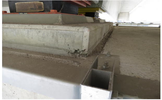
⑩ 받침콘크리트 파손 0.1m x 0.1m
