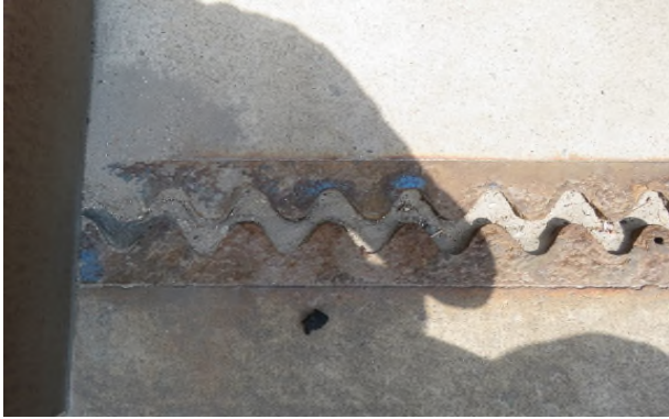
② 신축이음 토사퇴적 및 부식 0.5m (보수완료)
