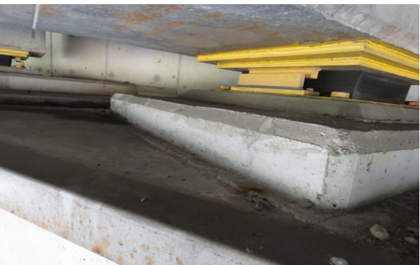
⑯ 받침콘크리트 파손 0.2m x 0.4m (보수완료)
