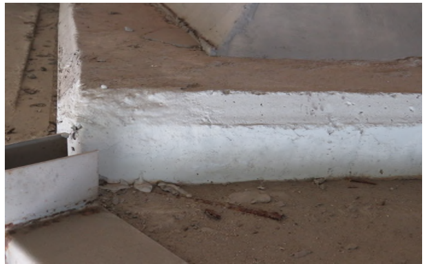
⑬ 받침콘크리트 재료분리 0.1m x 0.1m (보수완료)
