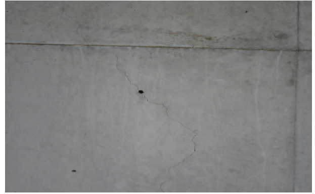
⑳ 균열 0.2mm / 1.0m
