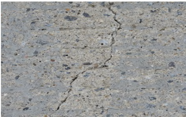
⑤ 균열 0.1mm / 2.0m
