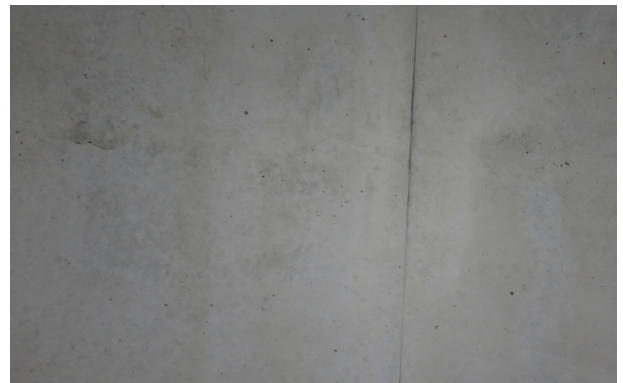
㉒ 균열 0.2mm / 2.0m
