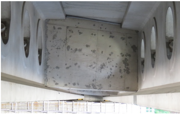
⑥ 균열 0.8m x 0.1m (2EA) (보수완료)
