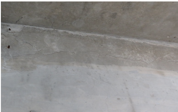
⑲ 균열 0.3mm / 1.0m
