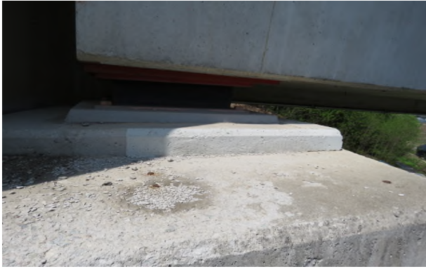
⑤ 받침콘크리트 재료분리 0.1m x 0.5m (보수완료)
