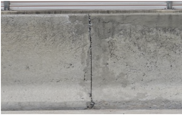
① 균열 0.2mm / 1.0m
