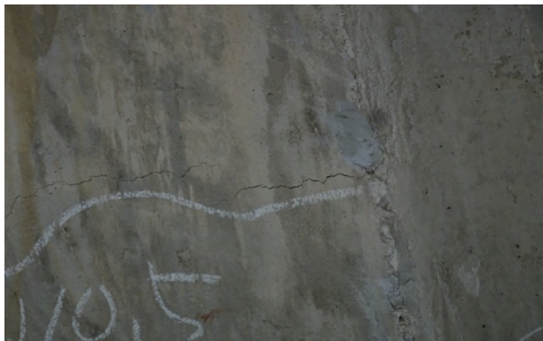
⑪ 균열 0.1mm / 0.5m
