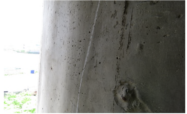
㉕ 거더 단부 균열 (0.3mm미만) cw=0.2mm / 1.5m
