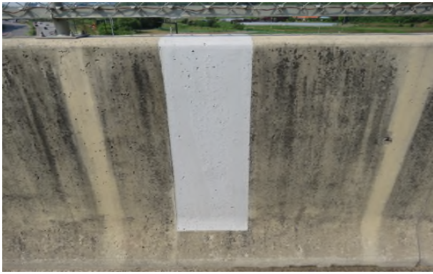
⑰ 균열 (0.3mm미만) cw=0.2mm / 1.3m (보수완료)
