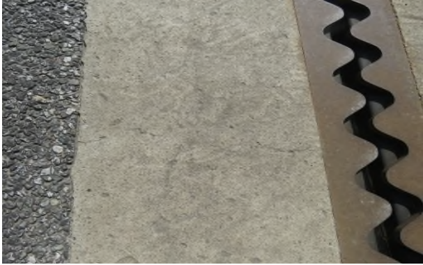
① 후타재 균열 (0.3mm미만) cw=0.1mm / 0.4m (2EA)
