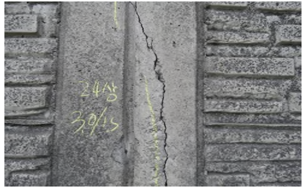
② L형측구 균열 cw=1.0\text{mm} / 0.3m
