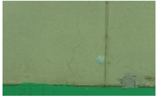
④ 균열 0.2mm / 0.8m (5EA)
