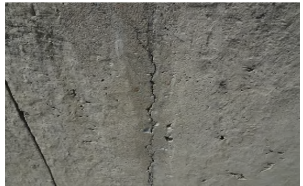
⑮ 균열 0.3mm / 1.0m
