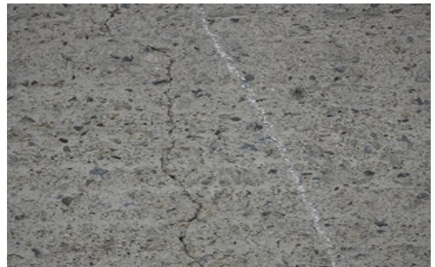
⑨ 균열 0.2mm / 2.0m
