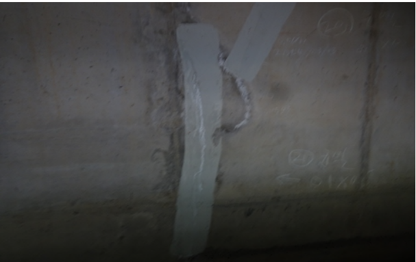
㉑ 균열 (0.3mm미만) cw=0.1mm / 0.6m (보수완료)
