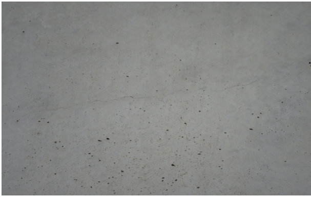
㉓ 균열 0.1mm / 1.0m
