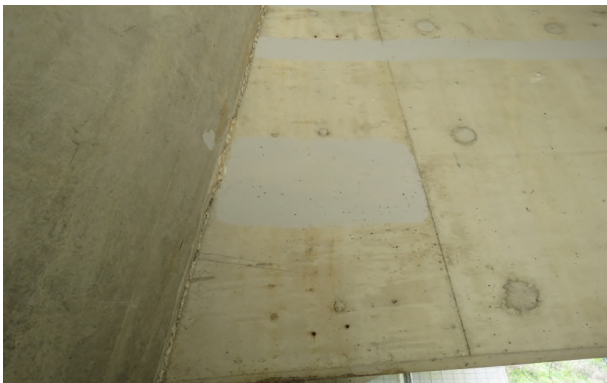
③ 가로보 균열 (0.3mm미만) cw=0.1mm / 2.0 m (보수완료)
