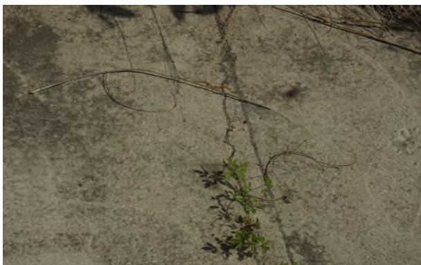
⑭ 균열 cw=1.0mm / 1.2m
