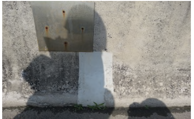
⑥ 균열부 백태 (0.3mm미만) cw=0.2mm / 0.6m
