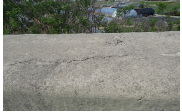
② 균열 cw=0.3\text{mm} / 0.5m
