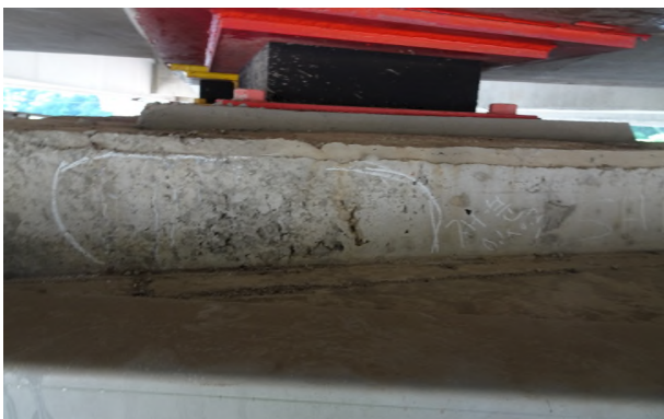
⑱ 받침콘크리트 재료분리 0.1m x 0.2m
