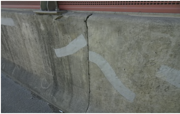
⑱ 균열 (0.3mm미만) cw=0.1mm / 0.3m (보수완료)
