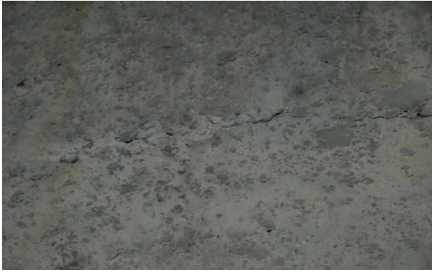
① 균열 0.3mm / 0.2m
