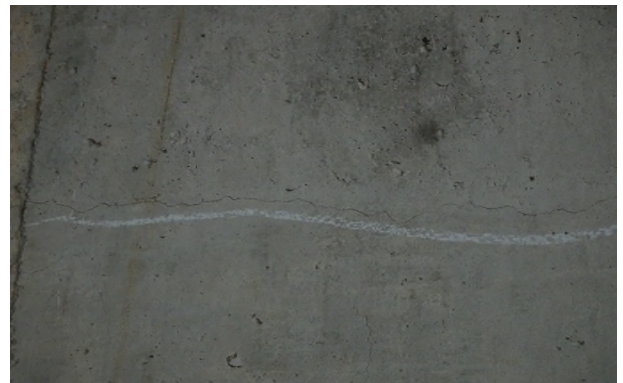
⑭ 균열 0.1mm / 1.0m
