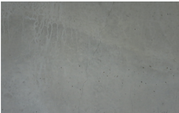
㉑ 균열 0.2mm / 3.0m
