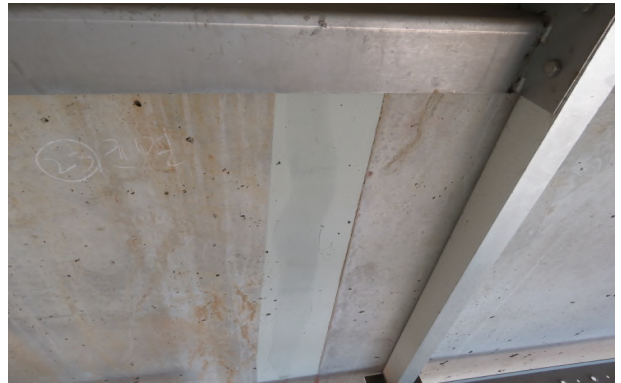
㉓ 균열(0.3mm미만) cw=0.05mm / 0.3m (보수완료)
