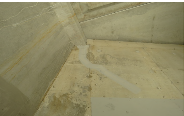
⑦ 가로보 망상균열 (0.3mm미만) cw=0.2mm / 1.0m x 1.0m (보수완료)
