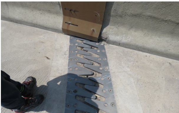
③ 신축이음부 이물질퇴적 L=1.0m
