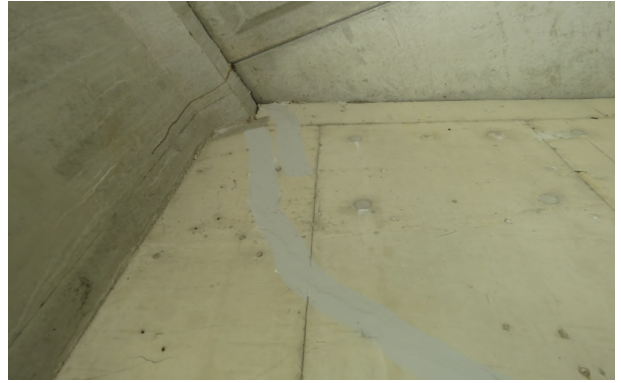
② 가로보 균열 cw=0.3mm / 1.0m (보수완료)
