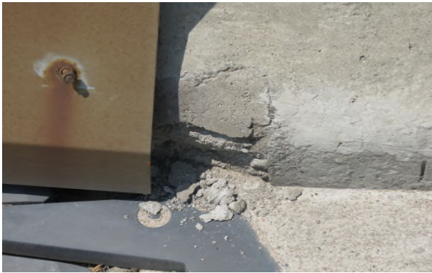
⑯ 파손 0.1m x 0.1m
