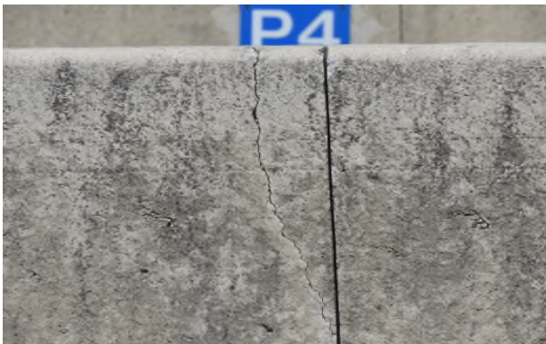
⑱ 균열 0.3mm / 1.0m
