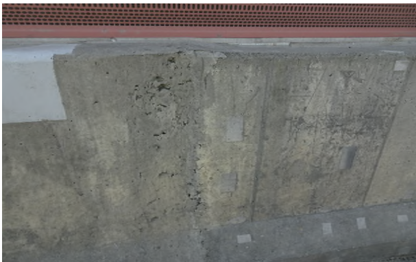
⑪ 파손 0.1m x 0.1m (보수완료)
