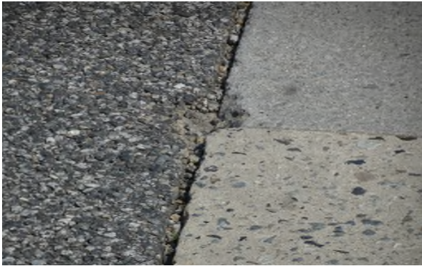
④ 후타재 파손 0.1m x 0.1m
