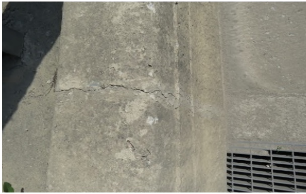
③ L형측구 균열 cw=0.5mm / 1.5m
