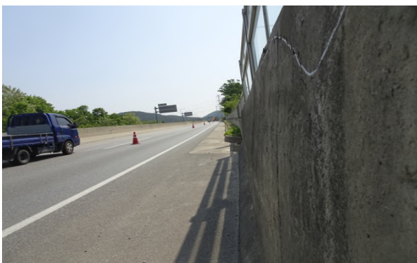
㉓ 균열 cw=0.3mm / 1.5m
