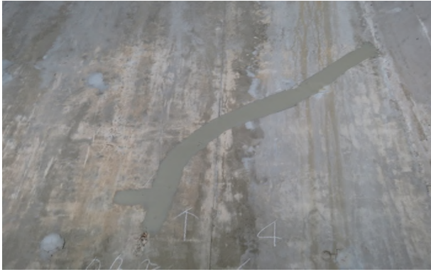
④ 균열 0.3mm / 0.8m (보수완료)
