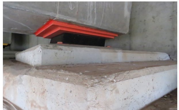
④ 받침콘크리트 재료분리 0.1m x 0.1m (보수완료)
