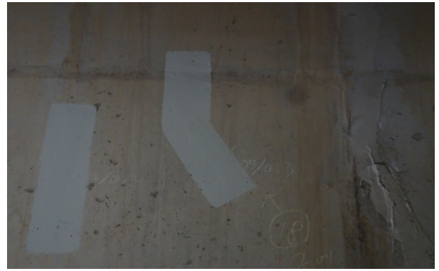
⑱ 균열 (0.3mm미만) cw=0.05mm / 0.3m (보수완료)
