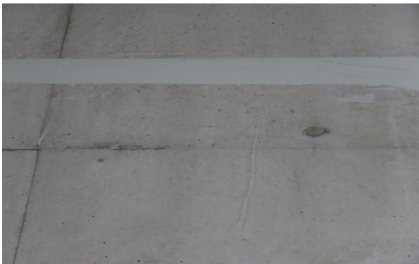
㉗ 균열 0.2mm / 2.0m
