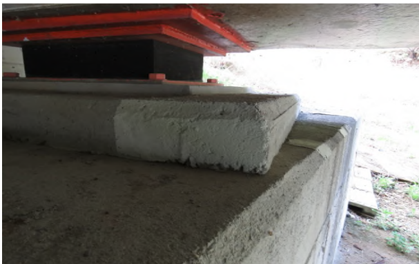
⑮ 받침콘크리트 재료분리 0.1m x 0.2m (보수완료)
