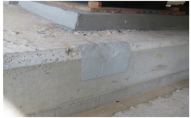
⑭ 받침콘크리트 파손 0.2m x 0.1m (보수완료)
