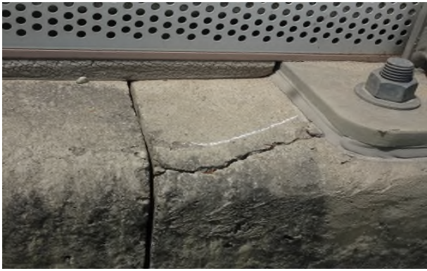
② 균열 0.3mm / 0.1m
