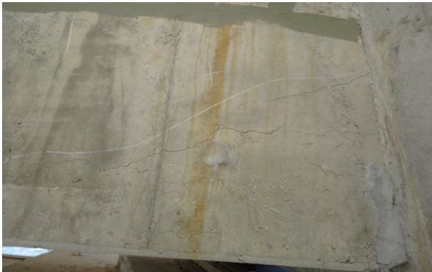
㉕ 균열 0.3mm / 0.6m
