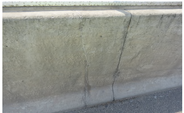
⑯ 균열 0.2mm / 1.4m
