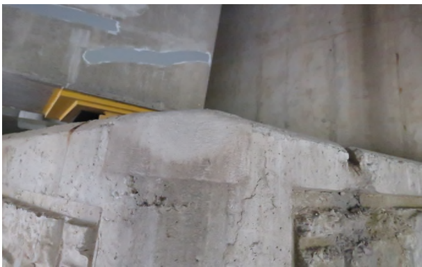
⑭ 파손 0.1m x 0.1m (보수완료)
