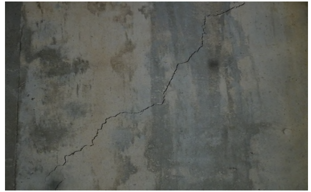
⑩ 균열 0.2mm / 0.1m
