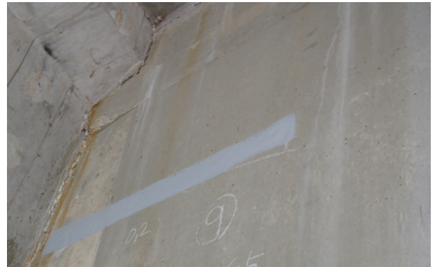
⑨ 균열 0.2mm / 0.6m (보수완료)
