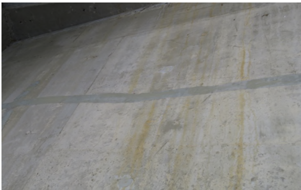
⑮ 균열 0.3mm / 2.0m (보수완료)
