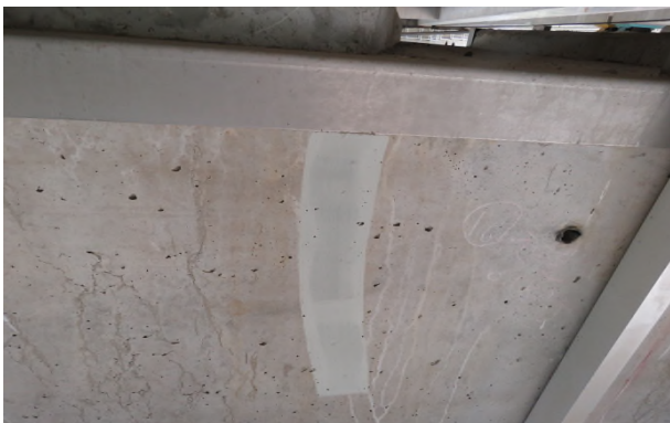
⑯ 균열(0.3mm미만) cw=0.1mm / 0.5m (2EA) (보수완료)
