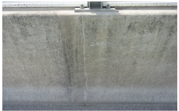
⑭ 균열 0.1mm / 1.4m
