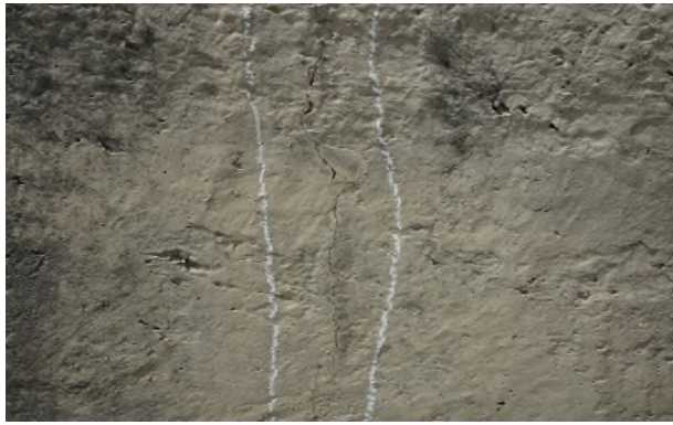
㉒ 균열 0.2mm / 1.0m
