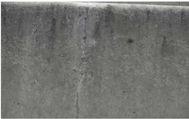
⑤ 균열 0.2mm / 1.5m
