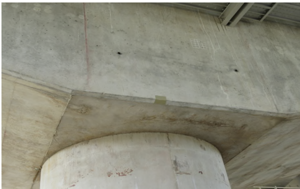
⑳ 파손 0.1m x 0.1m (보수완료)
