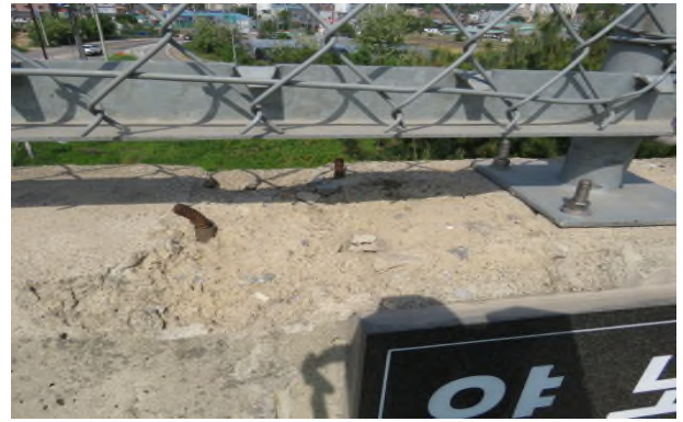
㉠ 파손 0.2m x 0.2m
