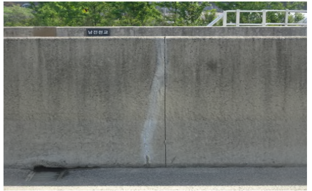
⑥ 균열 (0.3mm미만) cw=0.1mm / 0.4m(보수완료)
