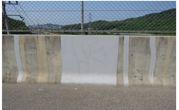
㉒ 망상균열 cw=0.3mm / 1.2m x 1.2m (보수완료)
