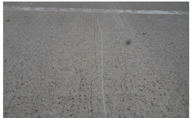
⑪ 균열 0.2mm / 1.0m (2EA)
