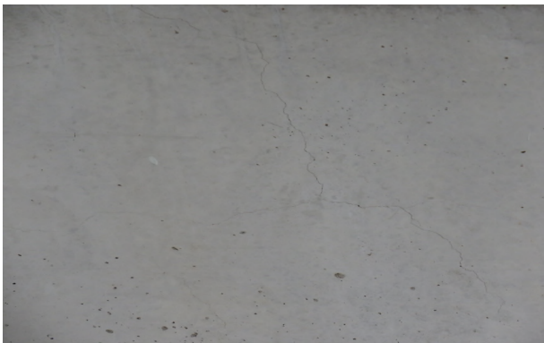
㉕ 균열 0.2mm / 2.0m
