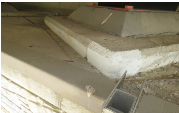
⑭ 받침콘크리트 파손 0.1m x 0.1m (보수완료)
