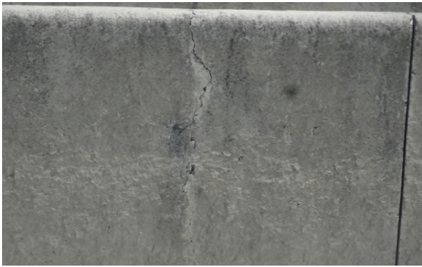
⑦ 균열 0.3mm / 0.5m
