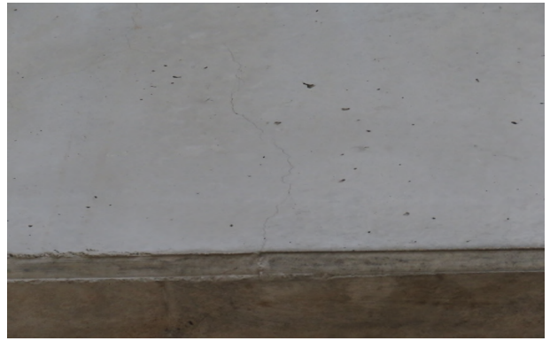
㉔ 균열 0.2mm / 1.0m
