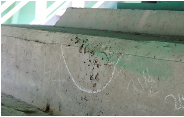
⑬ 받침콘크리트 재료분리 0.1m x 0.1m
