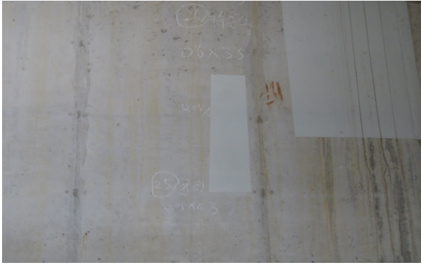
㉔ 균열 (0.3mm미만) cw=0.05mm / 0.3m (보수완료)
