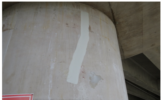
㉕ 균열 (0.3mm미만) cw=0.1mm / 1.0m (보수완료)
