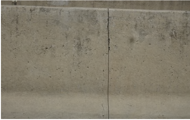
⑥ 균열 0.3mm / 1.0m
