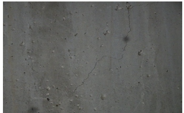
⑧ 균열 0.1mm / 0.1m
