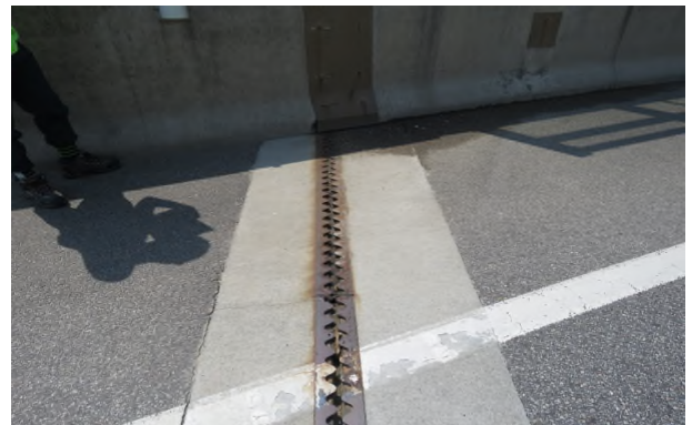
⑦ 신축이음 부식 및 퇴적 L=2.0m
