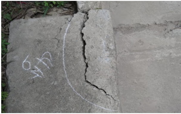
⑧ 균열 cw=0.2\text{mm} / 2.0\text{m}
