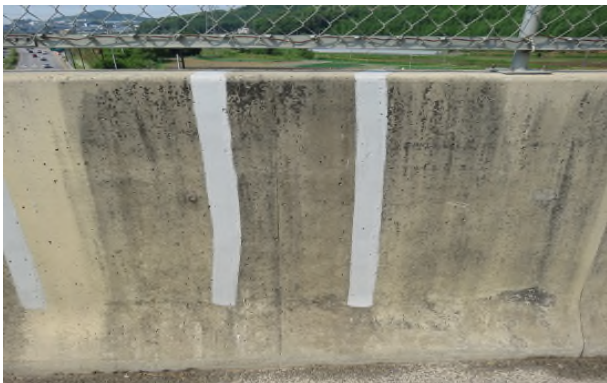
⑲ 균열 cw=0.3mm / 1.5m (2EA) (보수완료)
