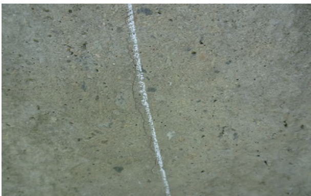
⑲ 균열 0.2mm / 1.2m
