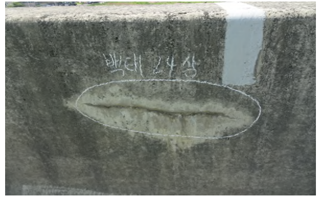
⑲ 균열부 백태 (0.3mm미만) cw=0.1mm / 0.8m
