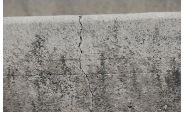
⑦ 균열 0.3mm / 1.0m
