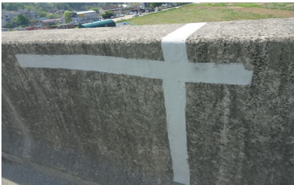
⑪ 균열 (0.3mm미만) cw=0.1mm / 0.8m (보수완료)
