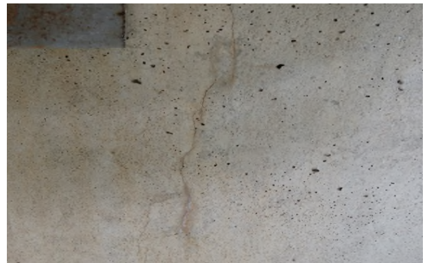
㉓ 균열 0.1mm / 0.7m
