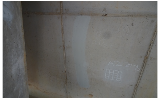
⑰ 균열 0.1mm / 0.5m (보수완료)
