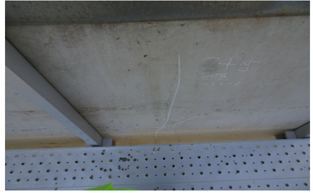
㉕ 균열 0.1mm / 1.3m
