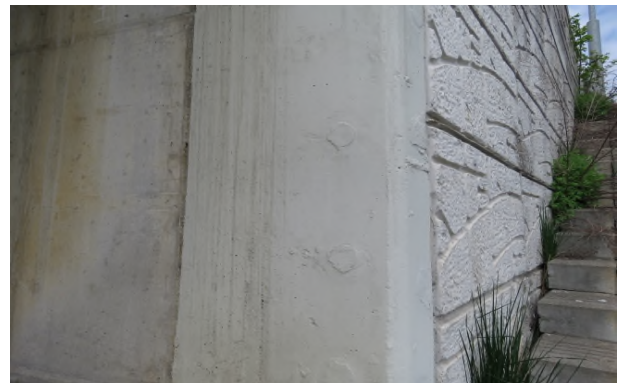
⑫ 보수부 콘크리트박리 0.1m x 0.1 (7EA) (보수완료)
