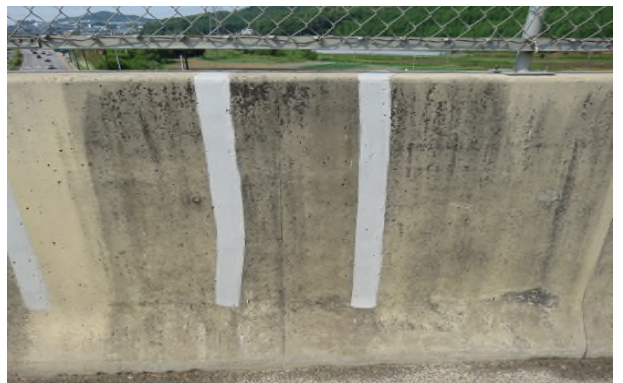
⑯ 균열 cw=0.3mm / 1.5m (2EA) (보수완료)
