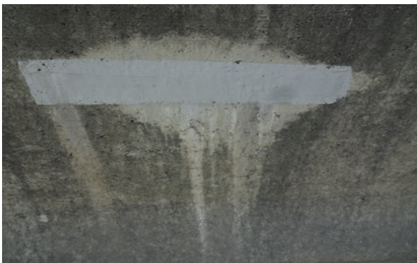
⑮ 균열부 백태 (0.3mm미만) cw=0.2mm / 0.5m (보수완료)
