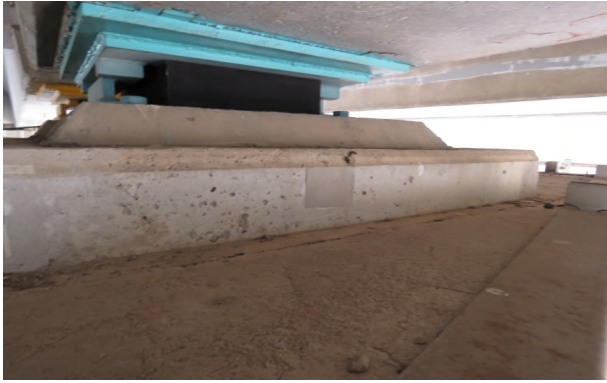
⑱ 파손 0.1m x 0.1m (보수완료)
