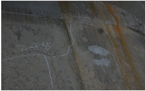
⑨ 균열 0.1mm / 0.5m
