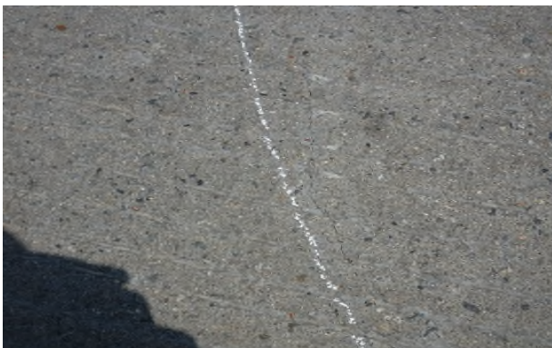
⑨ 균열 0.1mm / 43.0m
