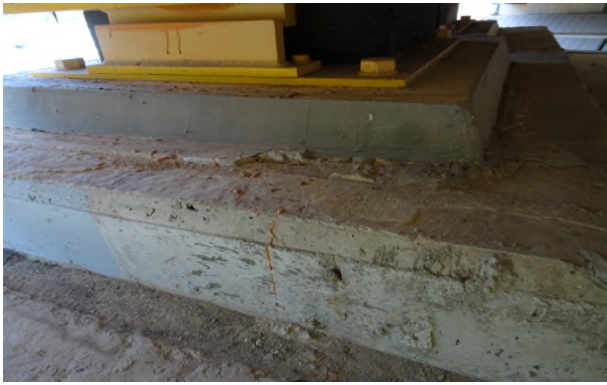
⑫ 받침콘크리트 재료분리 0.15m x 1.0m
