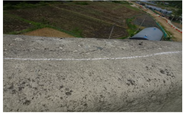
② 균열 0.2mm / 1.5m
