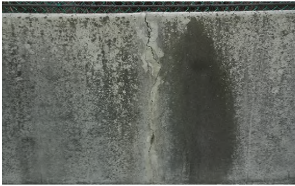
③ L형측구 균열 cw=2.0mm / 1.0m
