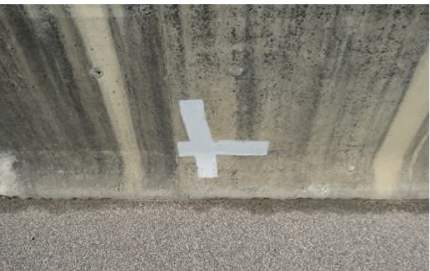
⑮ 균열 (0.3mm미만) cw=0.1mm / 0.8m (보수완료)
