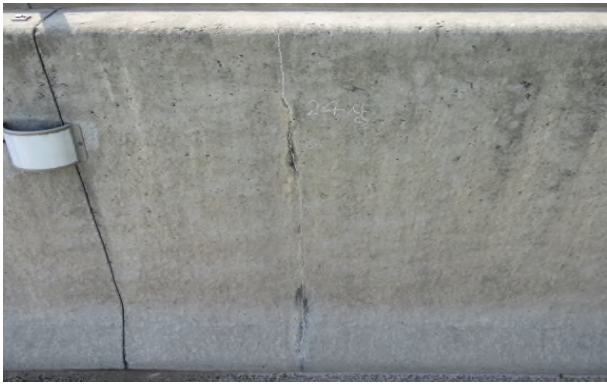
⑦ 균열 0.2mm / 1.4m
