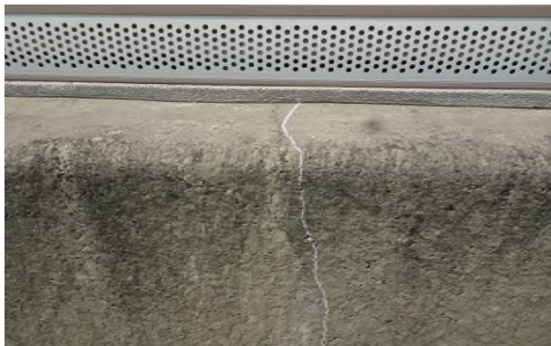
㉖ 균열 0.1mm / 0.4m
