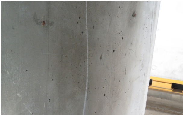
㉘ 거더 단부 균열 (0.3mm미만) cw=0.1mm / 1.0m
