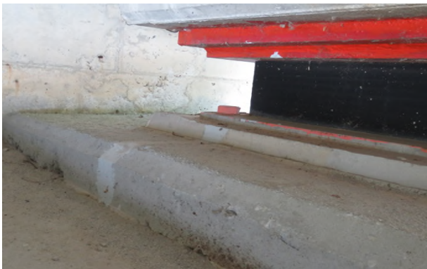
⑰ 받침콘크리트 재료분리 0.1m x 0.5m (보수완료)
