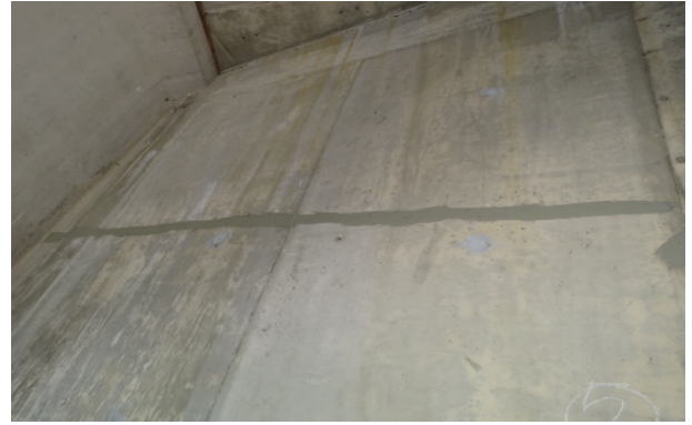
⑤ 균열 0.5mm / 2.0m (보수완료)
