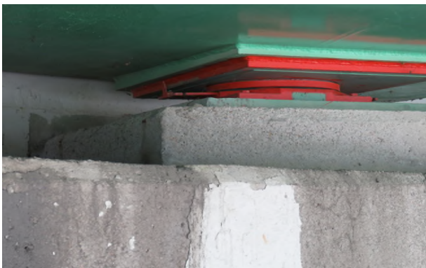
㉢ 받침콘크리트 열화 0.2m x 0.5m
