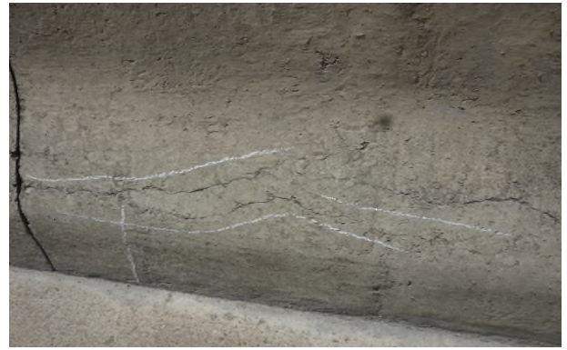
㉓ 균열 0.2mm / 3.0m
