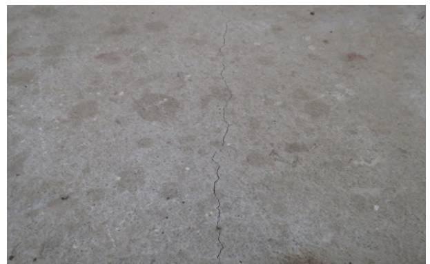
⑮ 균열 0.3mm / 3.0m
