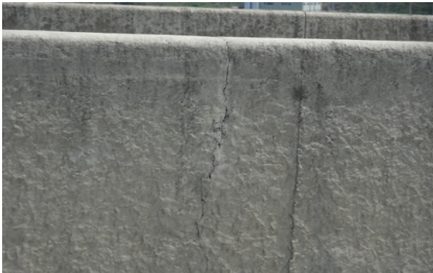
⑤ 균열 0.3mm / 1.5m
