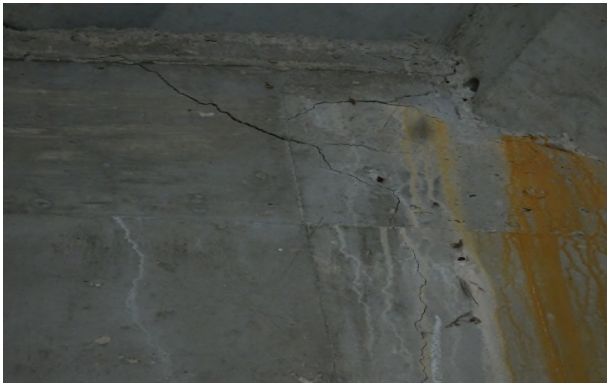
⑤ 균열 0.1mm / 1.0m
