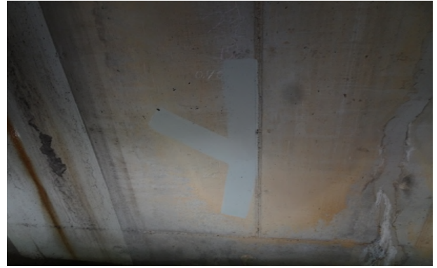
⑮ 균열 0.1mm / 0.9m (보수완료)
