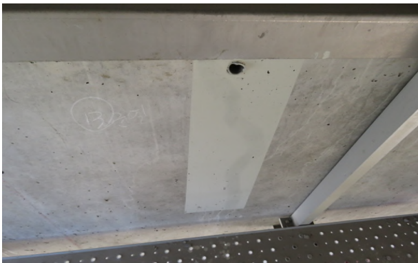
⑭ 균열(0.3mm미만) cw=0.05mm / 0.2m (보수완료)
