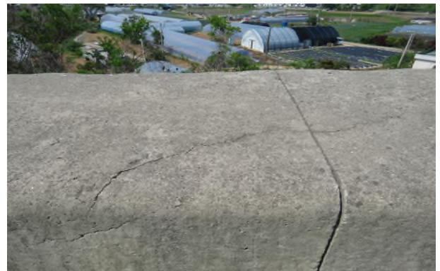
④ 균열 (0.3mm미만) cw=0.2\text{mm} / 0.6m
