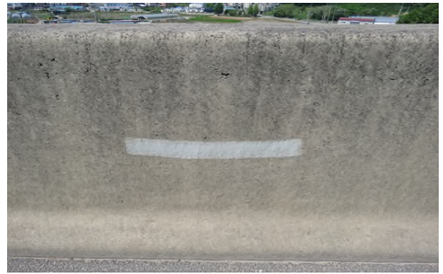
④ 균열 (0.3mm미만) cw=0.1mm / 5.0m (보수완료)
