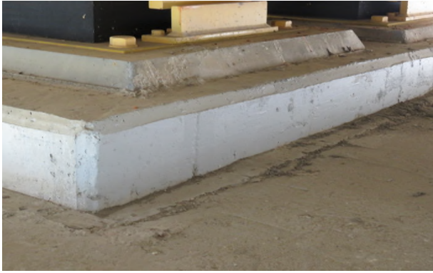
⑦ 받침콘크리트재료분리 0.15m x 2.5m (보수완료)
