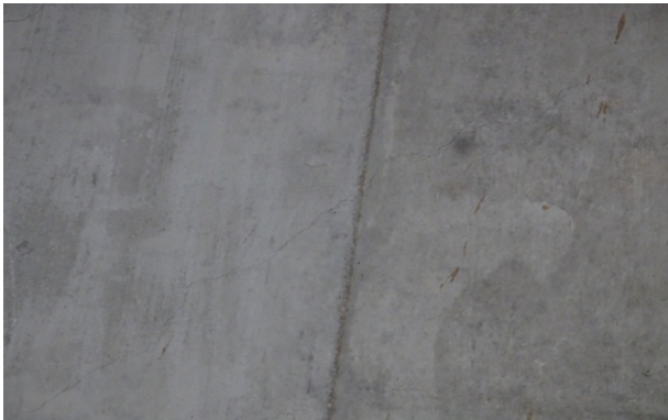
① 균열 0.2mm / 1.0m
