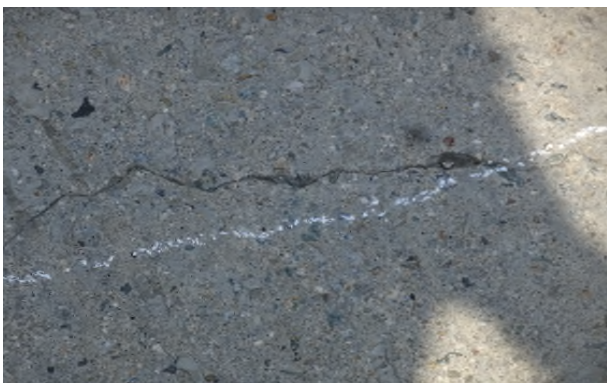
⑫ 균열 0.3mm / 1.0m
