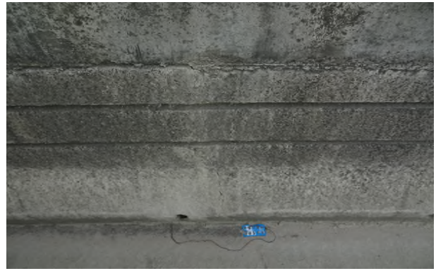
④ L형측구 균열 cw=0.6mm / 0.5m
