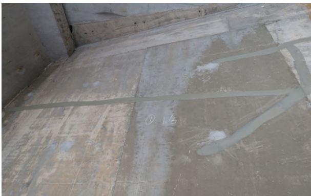
① 균열 0.1mm / 1.8m (보수완료)
