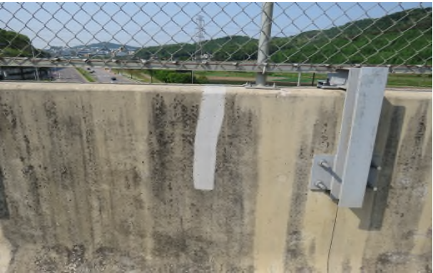
㉑ 균열 cw=0.3mm / 1.0m (보수완료)
