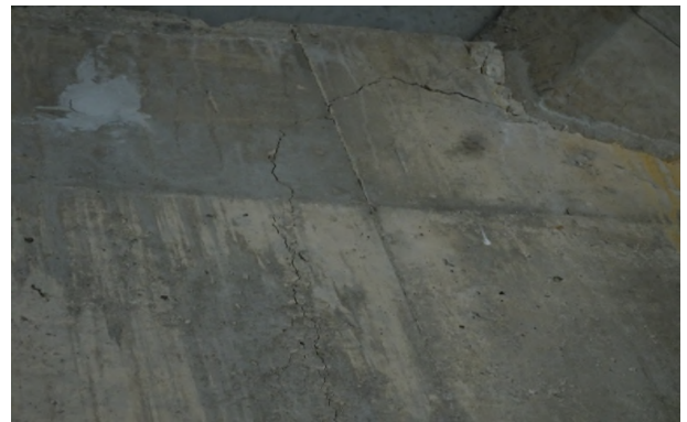
④ 균열 0.1mm / 2.0m
