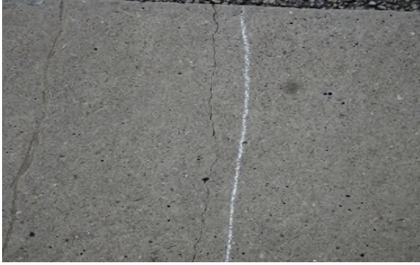
⑥ 후타재 균열 (0.3mm미만) cw=0.1\text{mm} / 0.2\text{m} (9EA)
