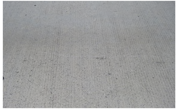
④ 균열 0.1mm / 1.0m
