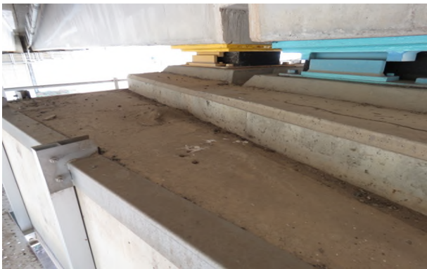
⑦ 받침콘크리트 잡철물미제거 1(EA)
