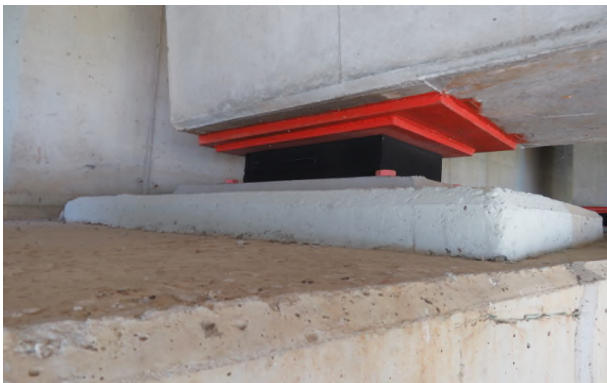
⑦ 받침콘크리트재료분리 0.1m x 1.0m (보수완료)
