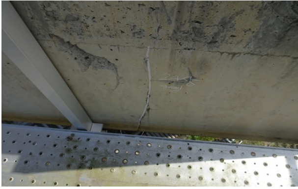
㉔ 균열 0.1mm / 0.7m
