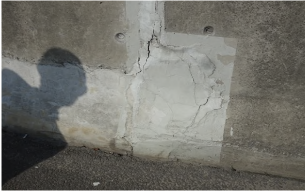
① 파손 0.6m x 0.4m (보수완료)
