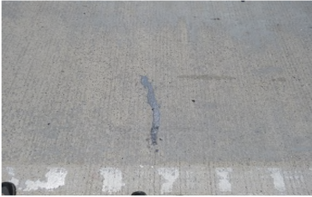
① 균열 0.1mm / 0.2m (보수완료)
