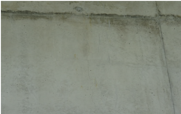
⑭ 균열 0.2mm / 3.0m
