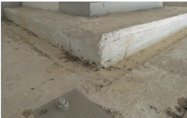
⑧ 받침콘크리트 재료분리 0.1m x 0.4m
