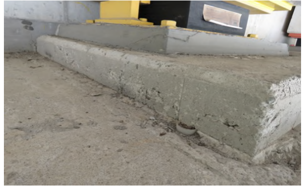
⑦ 받침콘크리트 재료분리 0.1m x 0.3m
