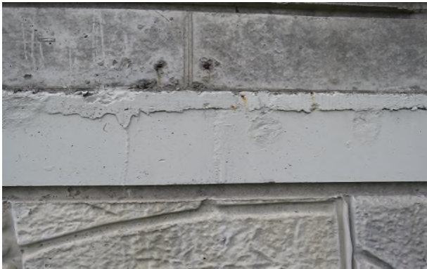
⑬ 파손 0.1m x 0.1m (9EA) (보수완료)
