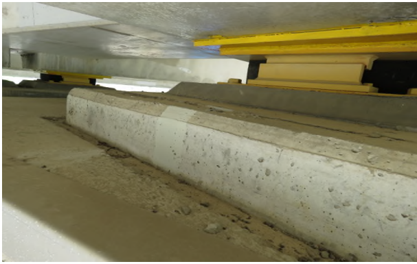
③ 받침콘크리트 균열 cw=0.3\text{mm} / 0.3\text{m} (보수완료)
