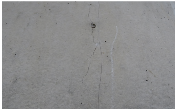
㉘ 균열 0.1mm / 0.1m (2EA)
