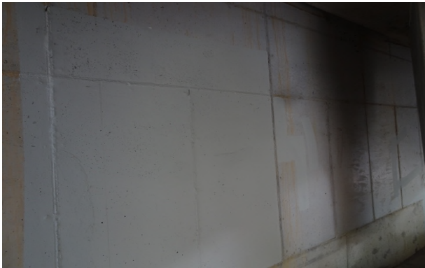
⑩ 균열 0.1mm / 5.0m (보수완료)
