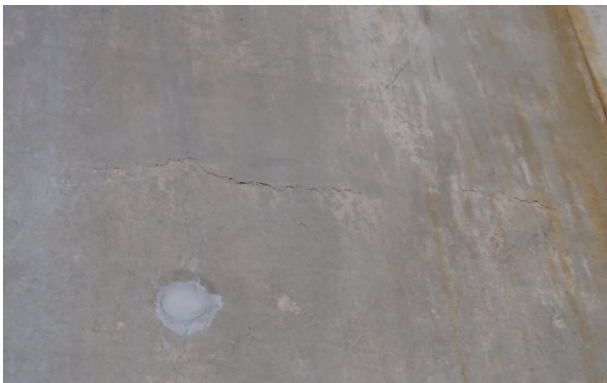
㉓ 균열 0.3mm / 1.0m
