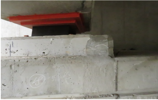
⑱ 파손 0.1m x 0.1m (보수완료)
