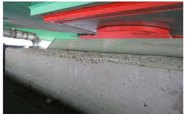
⑩ 받침콘크리트 재료분리 0.1m x 0.2m
