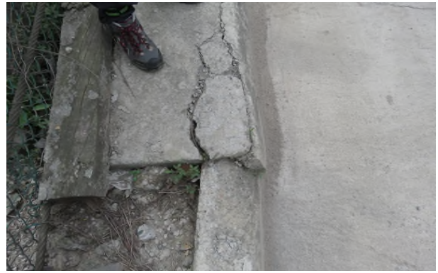
⑪ 파손 1.0m x 0.25m
