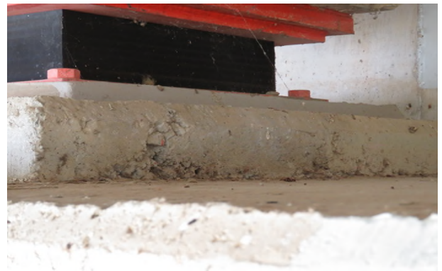
⑧ 받침콘크리트재료분리 0.1m x 0.2m
