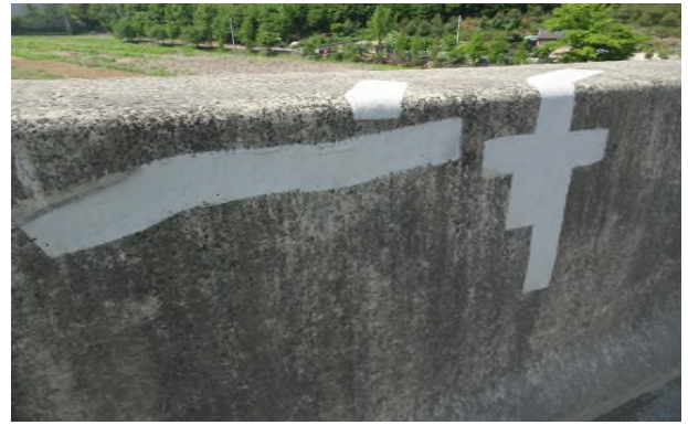
⑩ 균열 (0.3mm미만) cw=0.1mm / 0.8m (보수완료)
