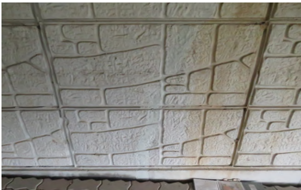
⑪ 균열 cw=0.3mm / 1.5m (2EA) (보수완료)
