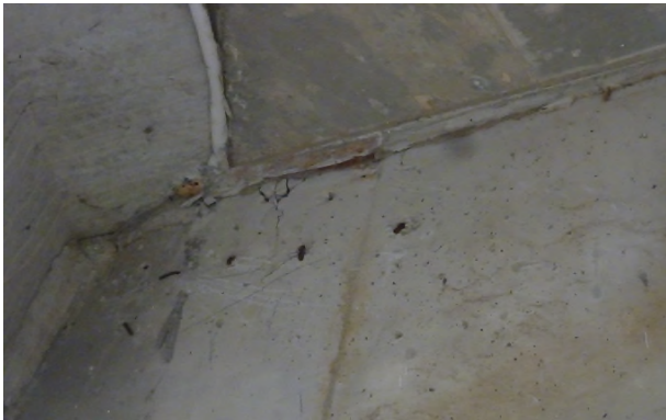
⑦ 균열 0.1mm / 0.1m
