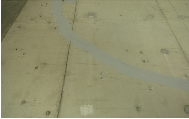
① 가로보 파손 0.1m x 0.5m (보수완료)
