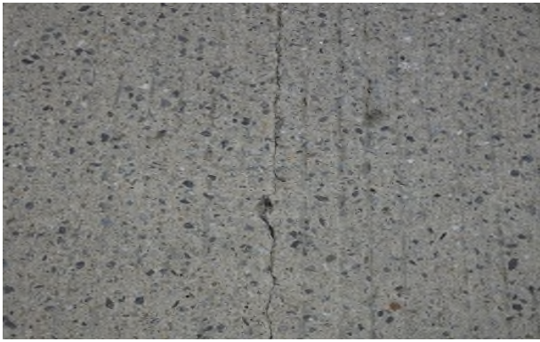
⑥ 균열 0.2mm / 2.5m
