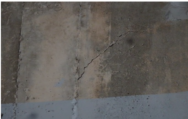
⑦ 균열 0.1mm / 0.1m
