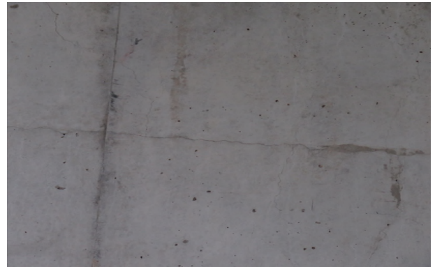
⑱ 균열 0.2mm / 2.0m
