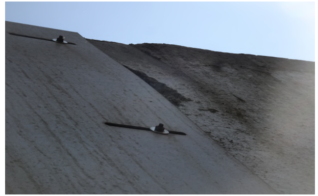
④ 파손 0.1m x 0.1m
