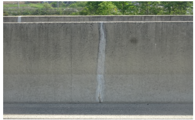
④ 균열 (0.3mm미만) cw=0.1mm / 0.3m (2EA) (보수완료)
