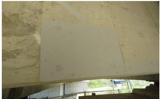
⑥ 가로보 균열 cw=0.3mm / 0.5m (보수완료)
