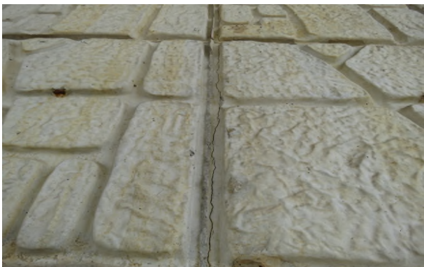
⑫ 균열 cw=0.3mm / 3.0m
