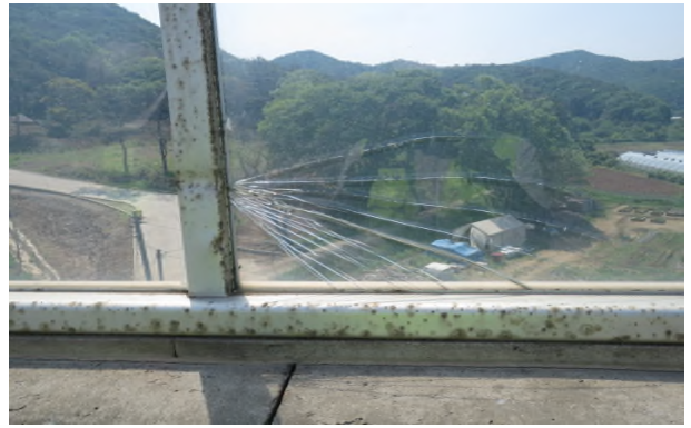
⑧ 방음벽유리 파손 0.2m x 0.3m
