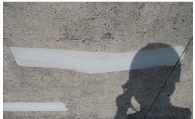
⑫ 균열 (0.3mm미만) 0.1m / 0.5m (2EA) (보수완료)
