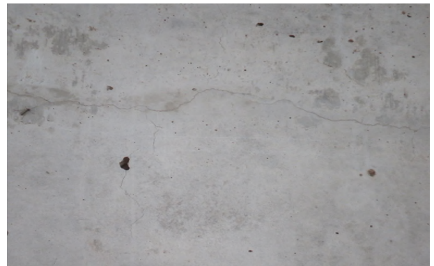
⑳ 균열 0.2mm / 1.5m
