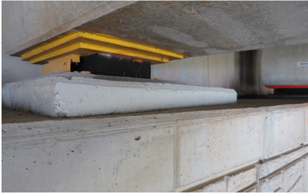
⑬ 받침콘크리트재료분리 0.1m x 1.0m (보수완료)
