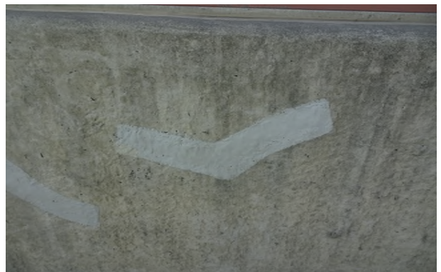
⑰ 균열 (0.3mm미만) cw=0.1mm / 0.5m (보수완료)
