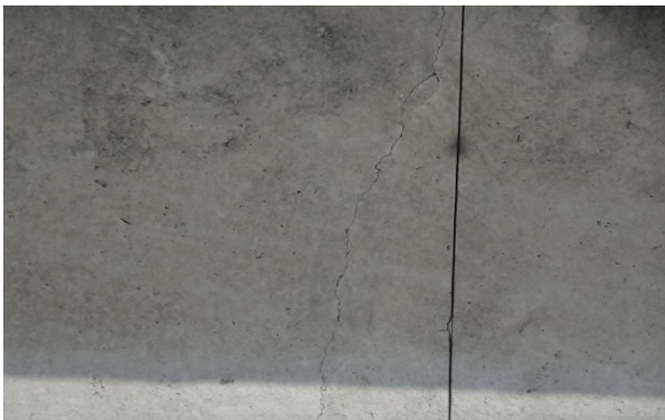
㉑ 균열 0.2mm / 1.2m
